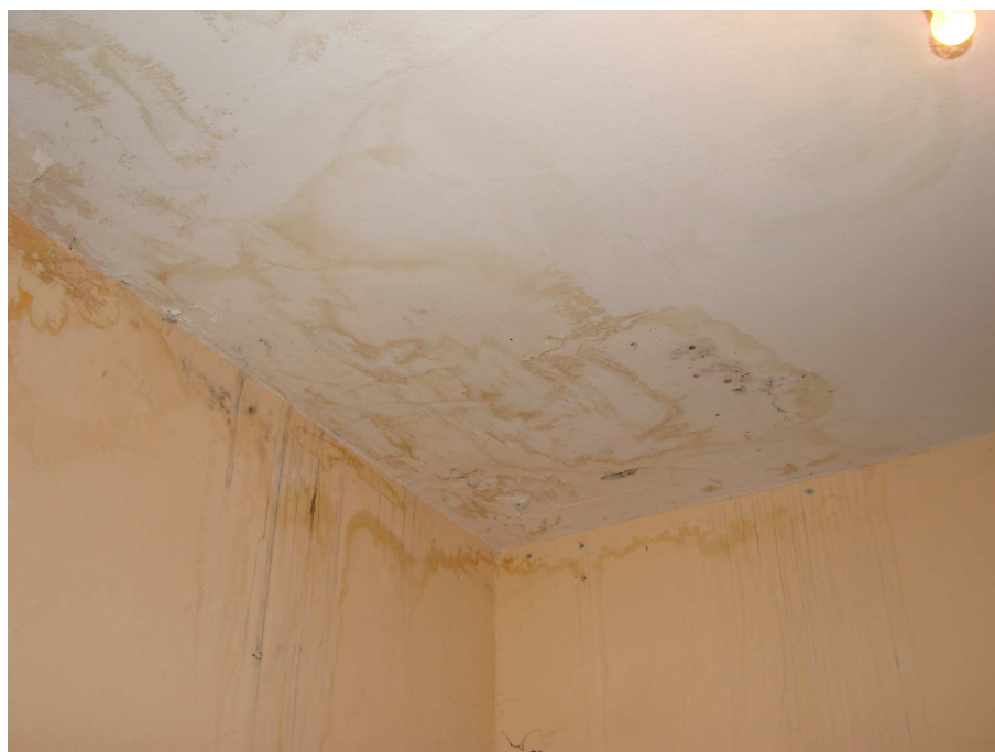
Fot. 10 – Przybudówka zachodnia. Ślady zacieków na suficie pomieszczenia.
