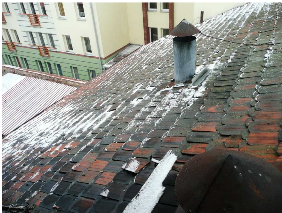
Fot. 5 – Widok połaci północnej bryły wschodniej. Widoczne zanieczyszczenie dachówek oraz skorodowany fragment ławy kominiarskiej.
