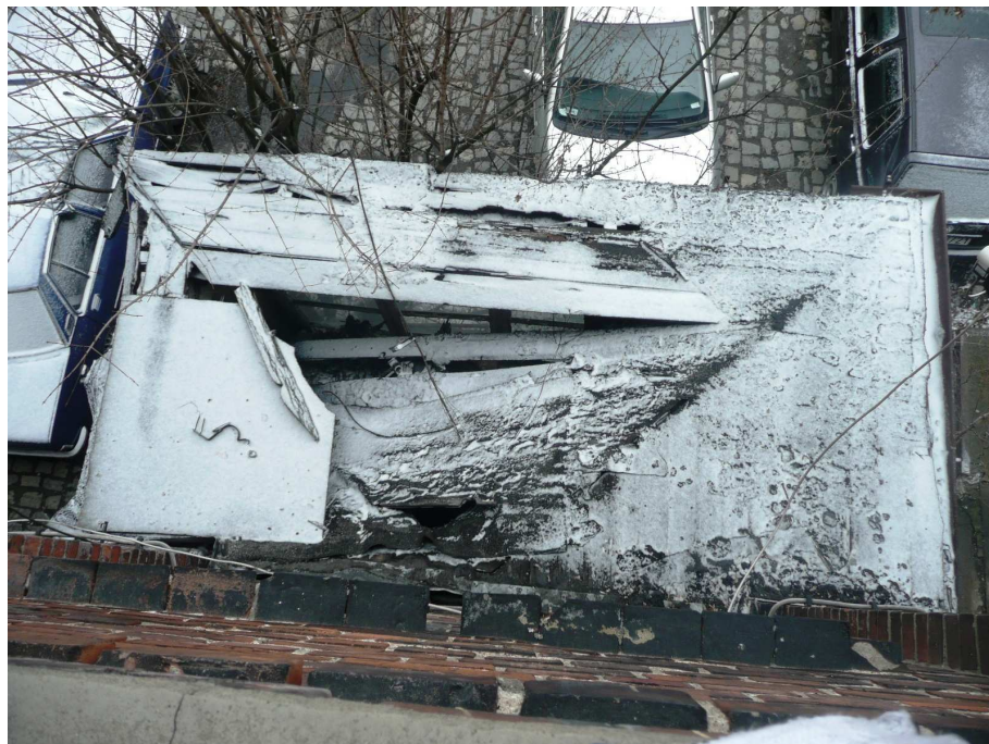
Fot. 15 – Bryła centralna. Widoczny uszkodzony daszek wiatrołapu.
