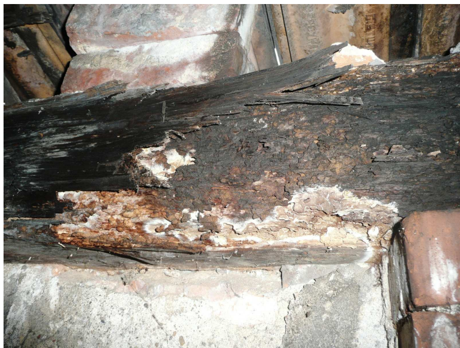
Fot. 13 – Bryła centralna. Skorodowany odcinek płatwi skrajnej. Widoczne chodniki larwalne oraz grzybnia grzyba domowego.
