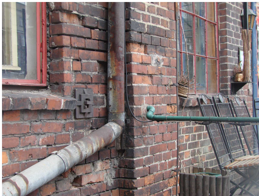
Fot. 7 – Widok fragmentu skorodowanej rury spustowej
