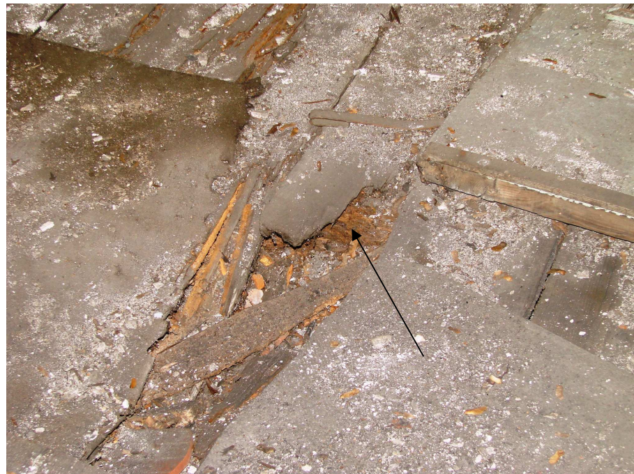
Fot. 14 – Bryła centralna. Fragment podłogi porażonej przez grzyba domowego. Widoczna zgnilizna porażonego drewna.
