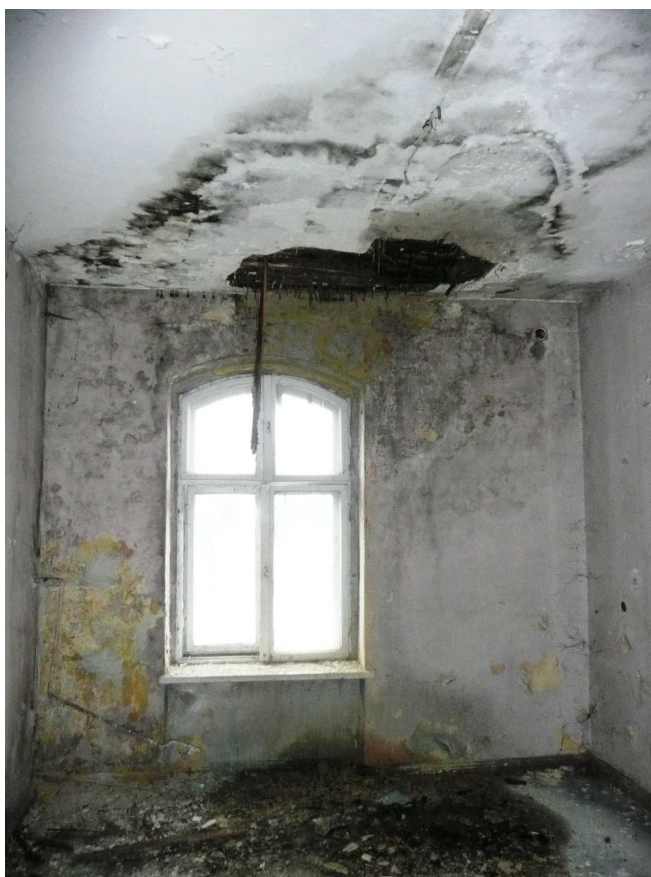
Fot. 8 – Widok uszkodzenia stropu strychowego od strony pomieszczenia I-go piętra. Widoczne porażenie ścian i sufitu przez grzyby pleśniowe.
