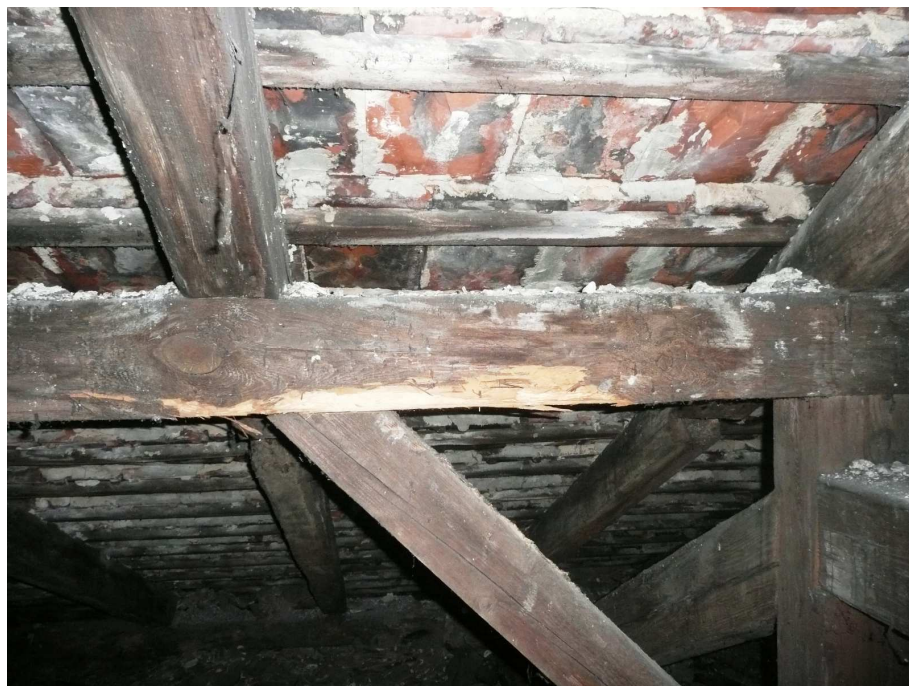
Fot. 17 – Bryła wschodnia. Widoczne porażenie płatwi przez owady
