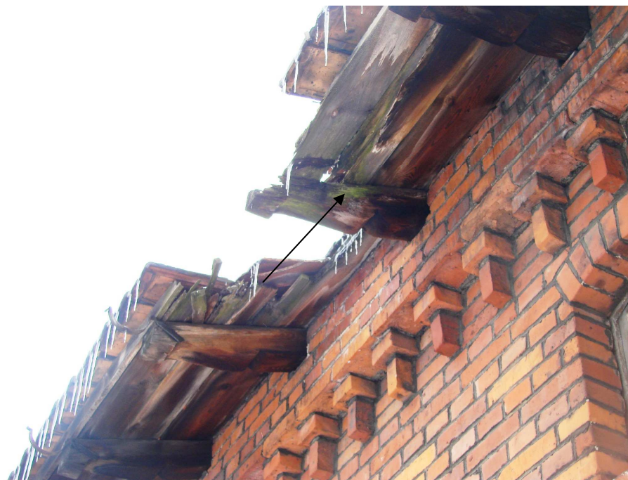
Fot. 6 – Widok fragmentu okapu północnego bryły centralnej. Widoczne uszkodzenie i porażenie przez glony i grzyba domowego deskowania i końcówek krokwi oraz brak rynny.
