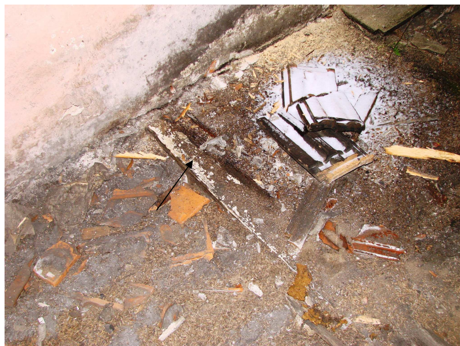
Fot. 12 – Bryła centralna. Widoczny brak desek podłogowych oraz grzybnia grzyba domowego na belce stropowej.
