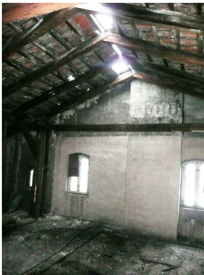
Fot. 4 – Widok fragmentu strychu bryły centralnej. Widoczne ubytki dachówki w kalenicy oraz inne prześwity.
