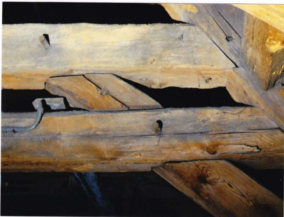
fot.58. Skrzydło północne – I kondygnacja. Węzeł konstrukcji rozporowej – widoczne ukośne szczeliny między elementami, powstałe w związku z odkształceniami poprzecznymi całej konstrukcji dachu.
