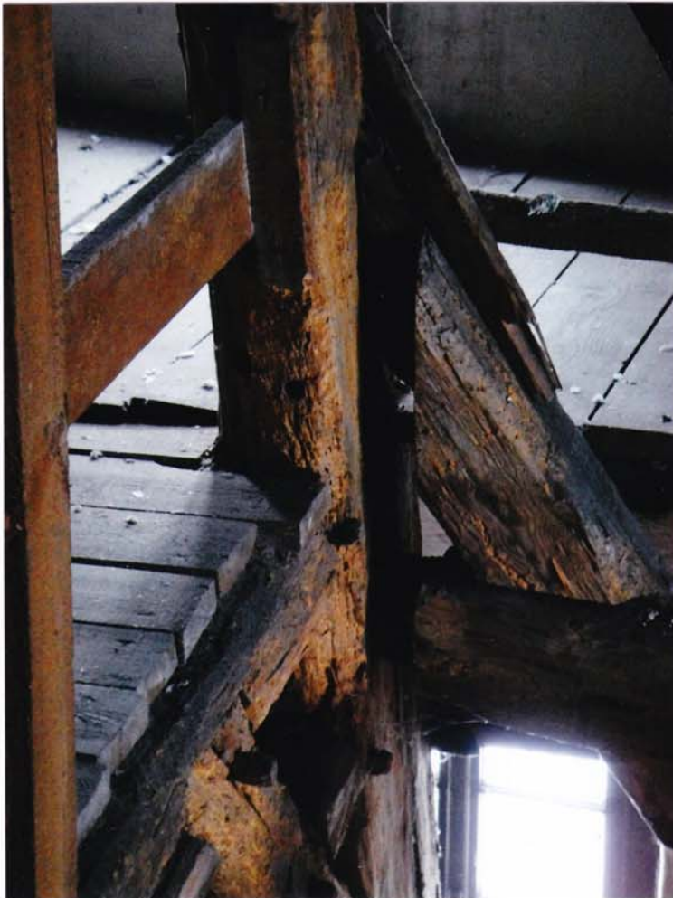
fot.34. Skrzydło zachodnie – II kondygnacja. Elementy w połączeniach są głęboko zniszczone przez owada Spuszczela, z głębokimi ubytkami drewna.
