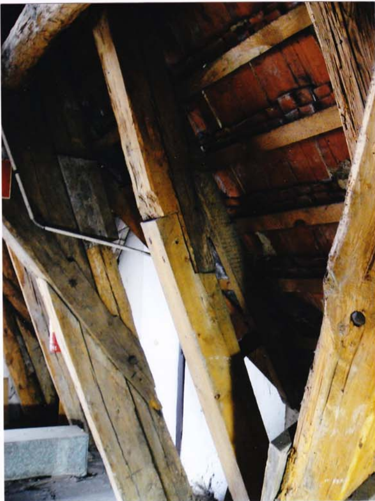
fot.36. Skrzydło zachodnie – I kondygnacja. Niewłaściwie wykonane połączenie krokwi. Tak połączony element nie jest w stanie przenieść działających obciążeń. W głębi widoczne spękane podłużnie elementy oraz szczeliny w połączeniu.
