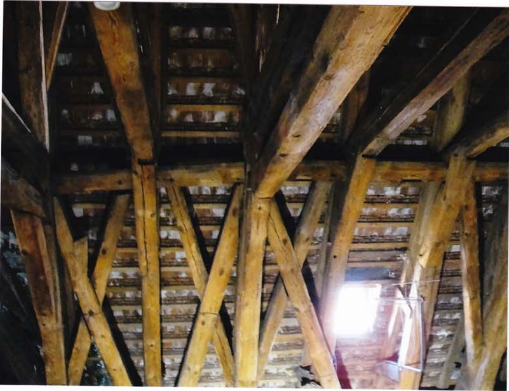
fot.57. Skrzydło północne – I kondygnacja. Widoczna płatew północna znacznie odkształcona, w związku z odkształceniami podłużnymi całej konstrukcji dachu.
