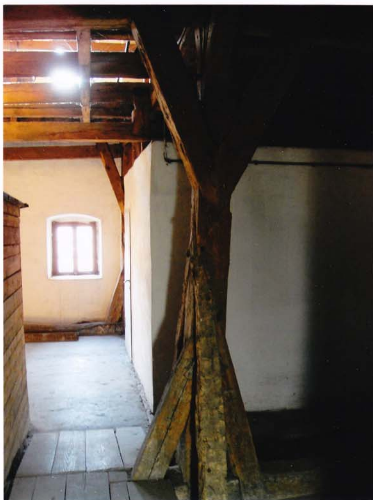
fot.56. Skrzydło północne – I kondygnacja. Widoczny słup środkowy silnie pochylony, w związku z odkształceniami poprzecznymi całej konstrukcji dachu.
