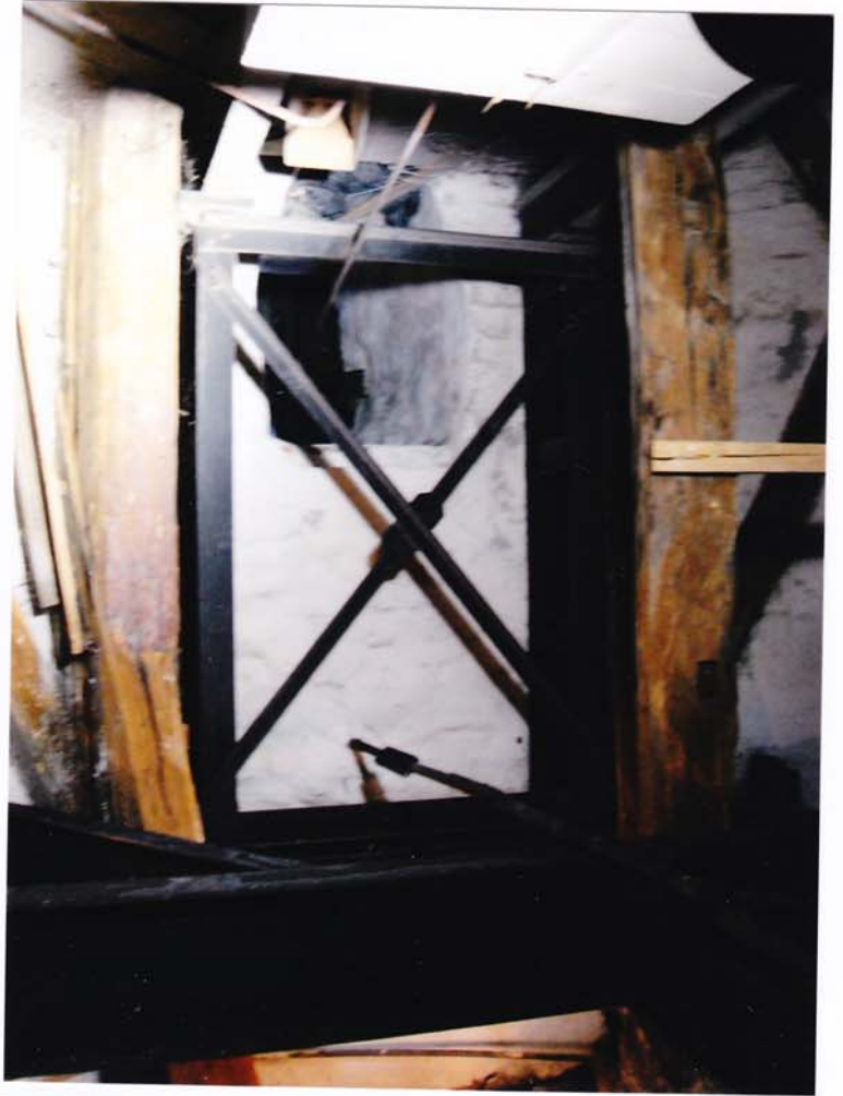
fot.83. Konstrukcja wsporczą niosąca helm – V kondygnacja. Widoczna konstrukcja stalowa wzmacniająca drewnianą konstrukcję wsporczą.
