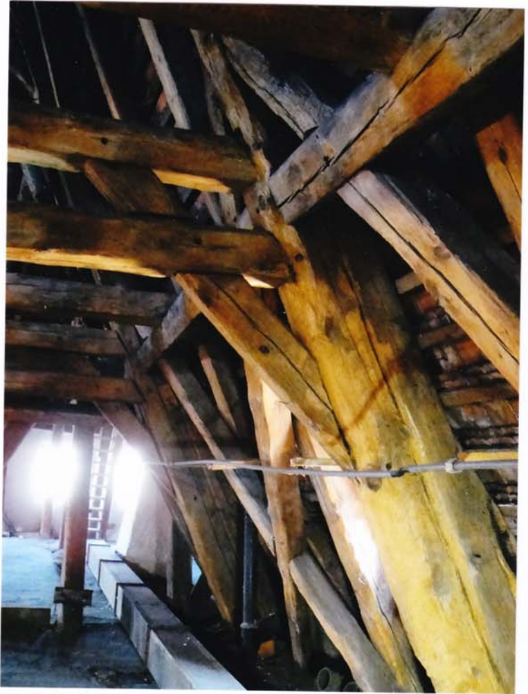
fot.17. Skrzydło południowe – I kondygnacja. Liczne elementy są spękanе podłużnie. Elementy konstrukcji rozporowej głęboko zniszczone przez owada Spuszczela, z ubytkami drewna.
