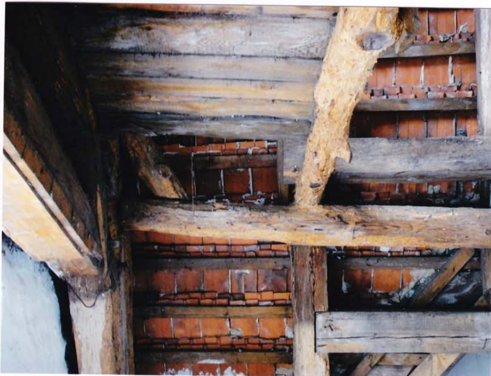
fot.42. Skrzydło zachodnie – I kondygnacja. Płatew i tram są głęboko zniszczone przez owada Spuszczela, z głębokimi ubytkami drewna, szczególnie w tramie, gdzie jego pierwotny przekrój wskazują zachowane sęki.
