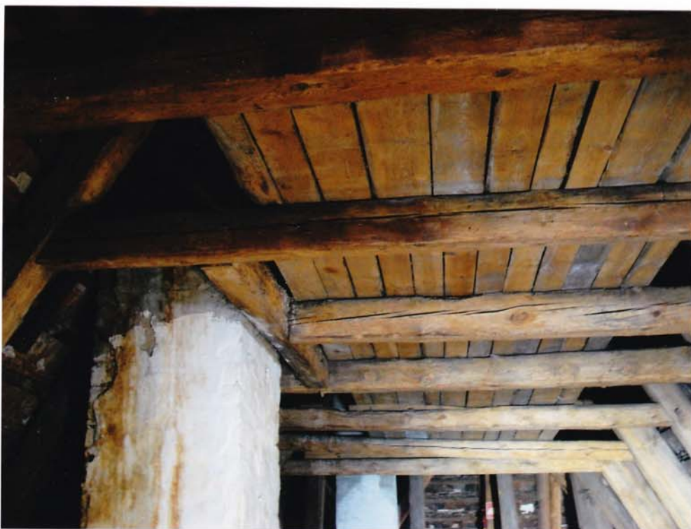
fot.51. Skrzydło północne – III kondygnacja. Tramy o znacznych spękaniach podłużnych i częściowo ukośnych.
