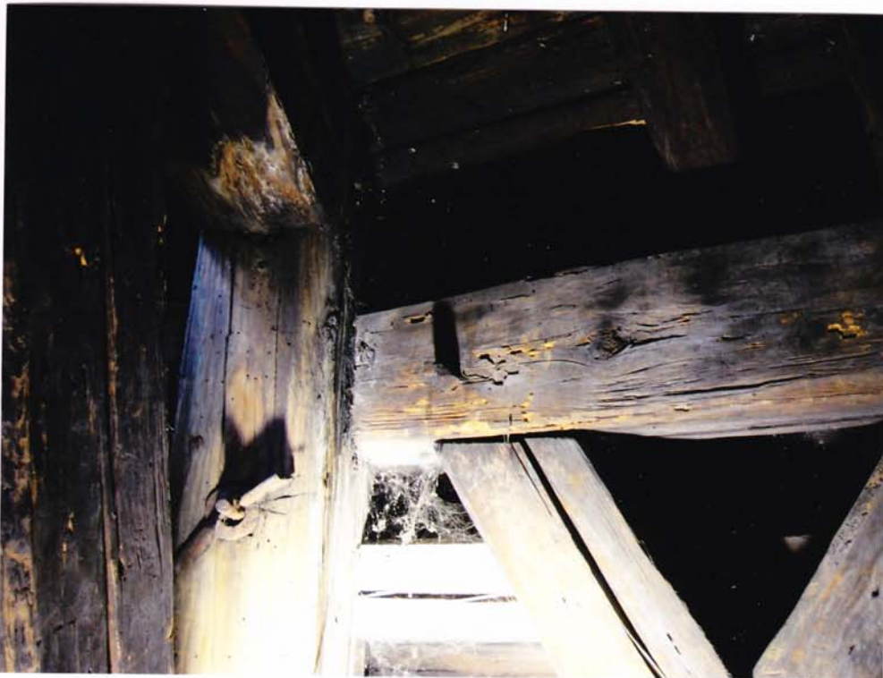
fot.76. Dolna partia helmu – widoczne mocowanie słupa elementem stalowym. Słup, zastrzał i element poziomy są pęknięte podłużnie. Pęknięcia o znacznej rozwarości.
