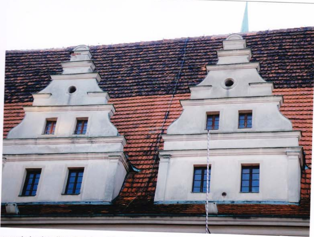
fot.5. Fragment dachu skrzydła zachodniego. Górą widoczne stare dachówki, dołem współczesne. W połaci dachowej widoczne odkształcenia.
