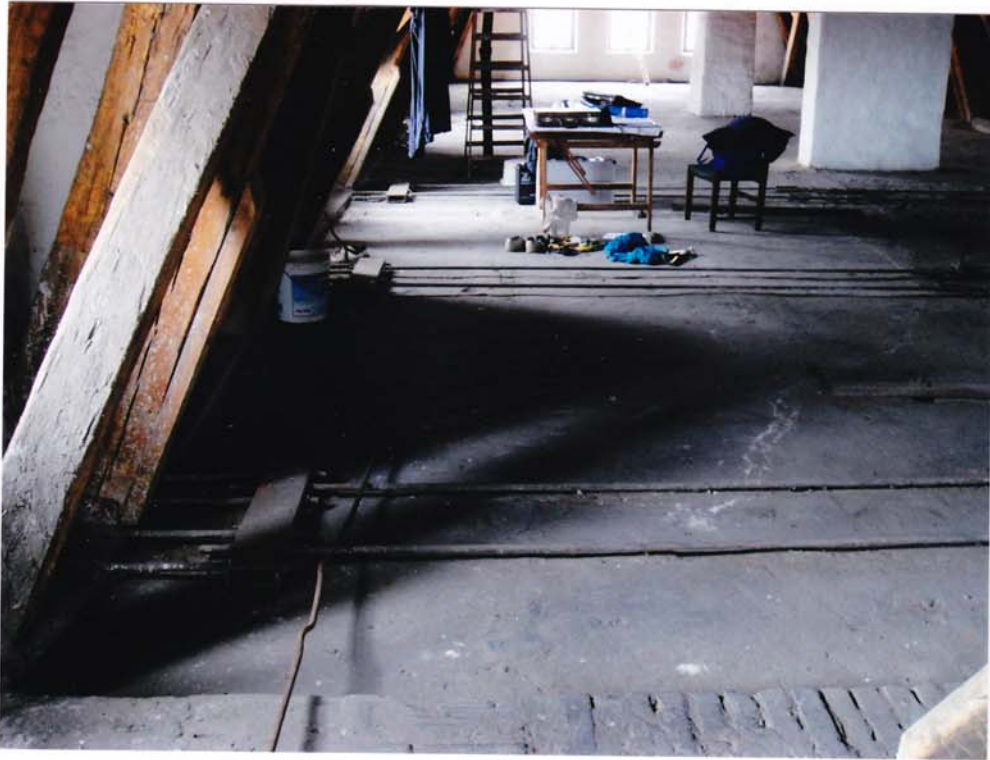
fot.43. Skrzydło zachodnie – I kondygnacja. W środkowej partii skrzydła zachodniego, ponad stropem masywnym I piętra, są ściągi stalowe napinane śrubami rzymskimi, spinające dołem konstrukcję rozporową więźby dachowej.
