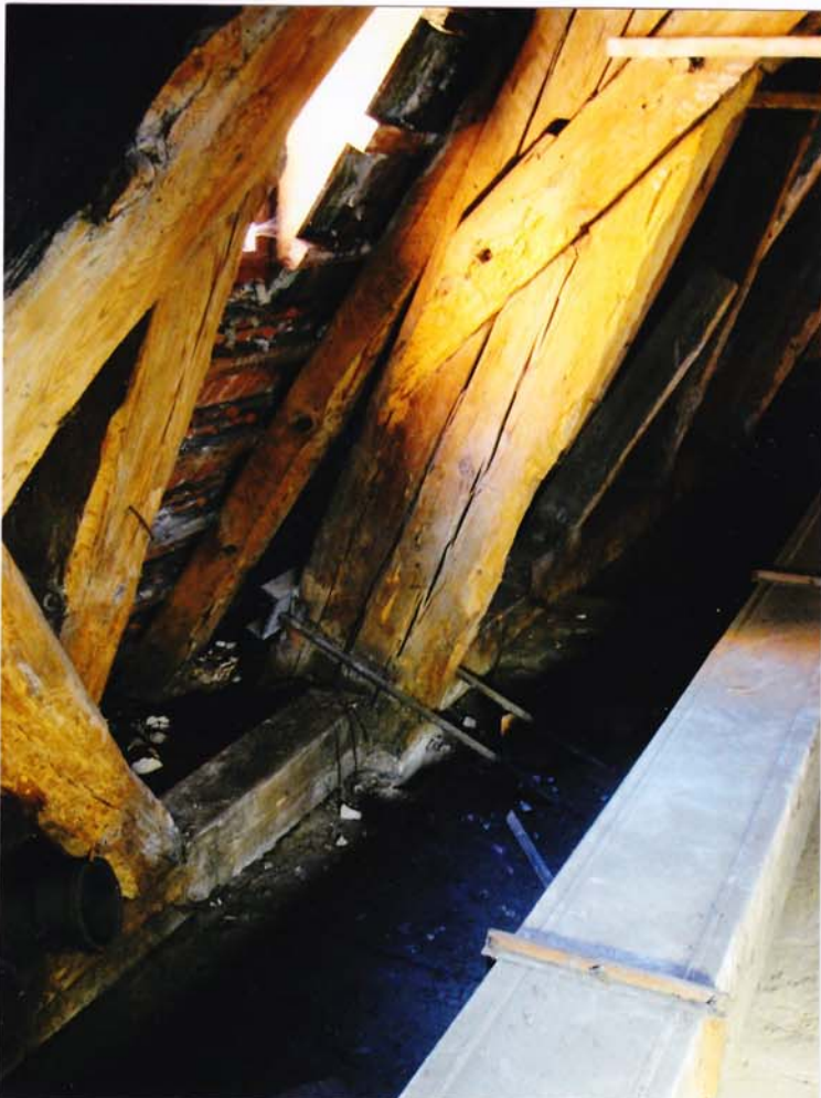
fot.18. Skrzydło południowe – I kondygnacja. Rozluźnione połączenie elementów, ze znacznymi szczelinami między elementami. W połączeniu brak kołka drewnianego. Elementy są spękanе podłużnie i częściowo głęboko zniszczone przez owada Spuszczela, z głębokimi ubytkami drewna.
