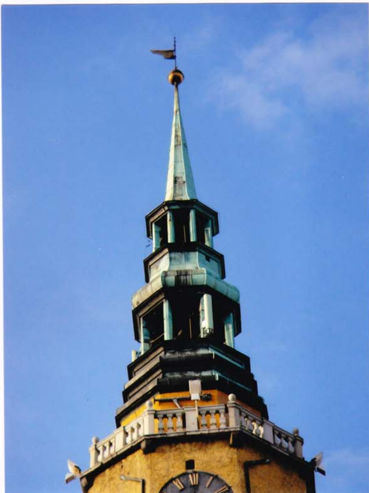
fot.62. Ponad tarasem wysoki hełm o konstrukcji drewnianej, kryty blachą miedzianą na deskowaniu. Na starym pokryciu widoczne ciemne ślady zacieków.
