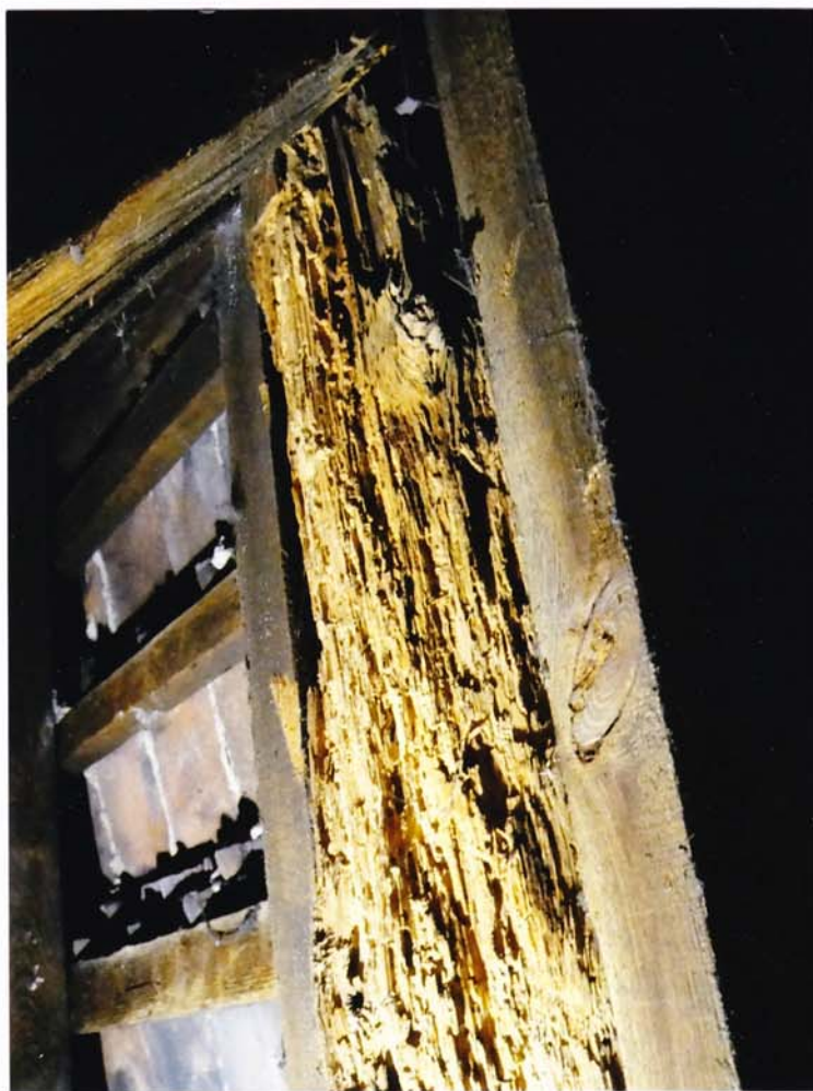
fot.21. Skrzydło zachodnie – IV kondygnacja. Krokiew głęboko zniszczona przez grzyb i owada Spuszczela, z głębokimi ubytkami drewna. Krokiew jest obustronnie wzmocniona przykładkami drewnianymi.
