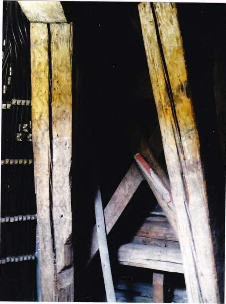
fot.75. Dolna partia helmu – widoczny słup i zastrzał pęknięte podłużnie na całej długości. Pęknięcia o znacznej rozwarości.
