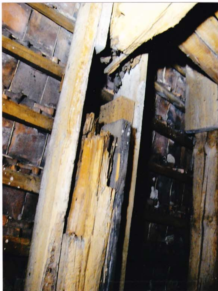
fot.26. Skrzydło zachodnie – III kondygnacja. Krokiew całkowicie zniszczona przez grzyb, z ubytkiem drewna na całą głębokość krokwi. Krokiew jest wzmocniona obustronnymi przykładkami drewnianymi.
