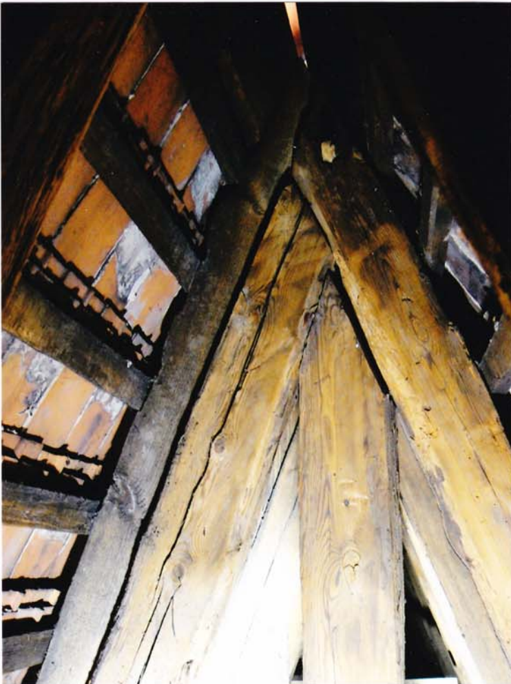
fot.20. Skrzydło zachodnie – IV kondygnacja. Górna partia więźby dachowej. Po lewej stronie element drewniany nałożony na krokiew, profilujący płaszczyznę dachu. Krokiew jest pęknięta podłużnie.
