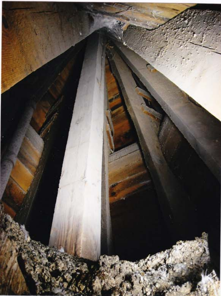
fot.102. Helm północny – górna partia helmu: niżej w formie kopuły, wyżej w formie ostrosłupa 8-bocznego. Widoczna drewniana konstrukcja ostrosłupa. Deskowanie pod pokryciem bez widocznych przecieków i uszkodzeń.
