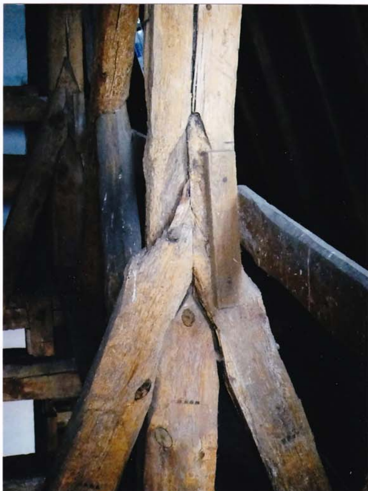
fot.24. Skrzydło zachodnie – III kondygnacja. Miecze zniszczona, z ubytkami drewna, w miejscu połączenia ze słupem.
