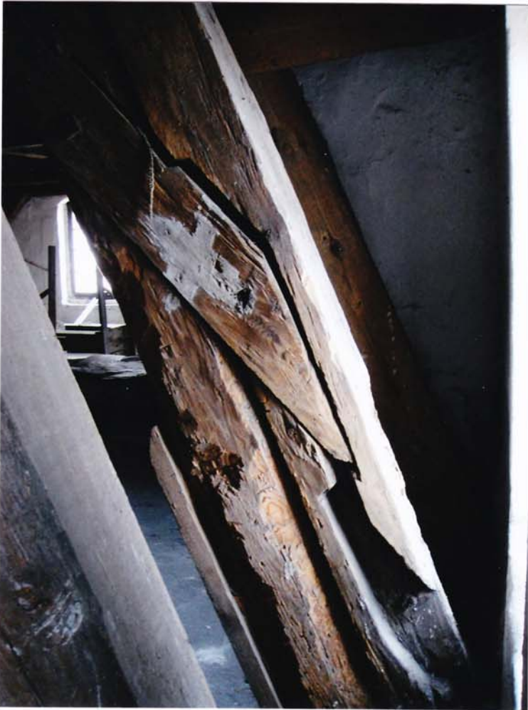
fot.41. Skrzydło zachodnie – I kondygnacja. Rozluźnione elementy konstrukcji rozporowej. W połączeniu widoczne szczeliny o znacznej rozwarości między elementami. W połączeniu brak zastrzału, na co wskazuje puste gniazdo w stolcu leżącym. Jeden z elementów jest głęboko zniszczony z głębokimi ubytkami drewna.
