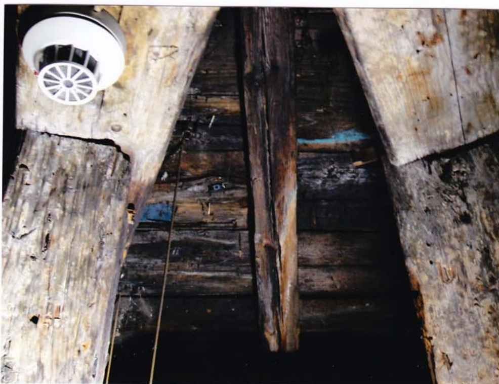
fot.74. Dolna partia helmu – na deskowaniu pokrycia widoczne ślady zacieków. Zastrzał pęknięty podłużnie na całej długości.
