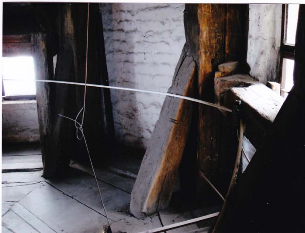
fot.88. Konstrukcja wsporcza niosąca hełm – II kondygnacja. Widoczne zastrzały dolne . W połączeniu zastrzału ze słupem szczelina o znacznej rozwarłości.
