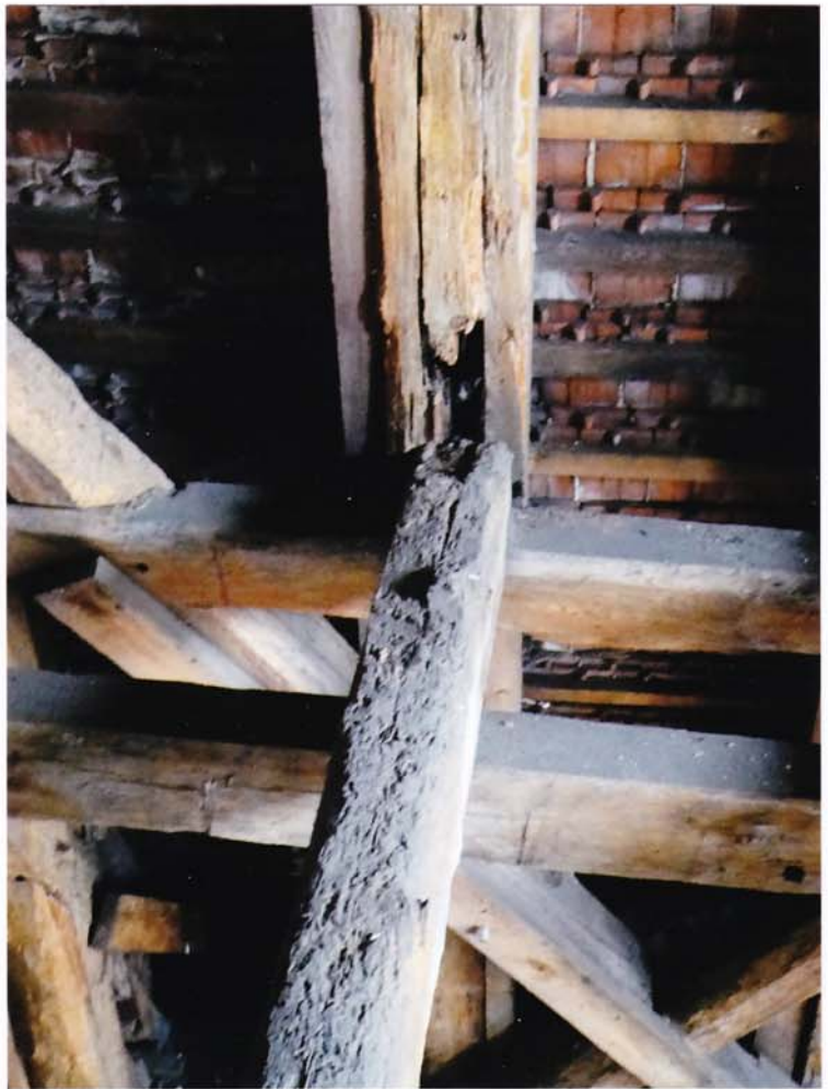
fot.33. Skrzydło zachodnie – II kondygnacja. Krokiew i tram są w połączeniu całkowicie zniszczone przez grzyb, z głębokimi ubytkami drewna. Krokiew jest wzmocniona obustronnie przyłatkami drewnianymi.
