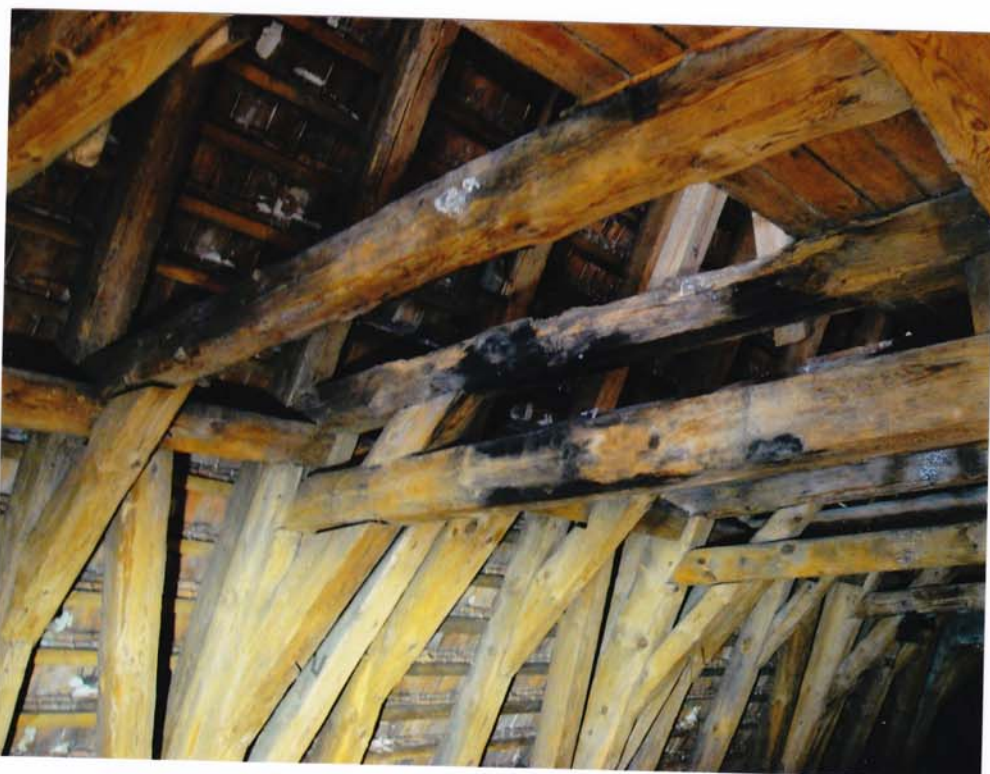
fot.53. Skrzydło północne – II kondygnacja. Na ryglach konstrukcji rozporowej ciemne ślady zwęglenia powstałe w trakcie lokalnego pożaru. Część elementów jest zniszczona przez owada Spuszczela, z głębokimi ubytkami drewna.
