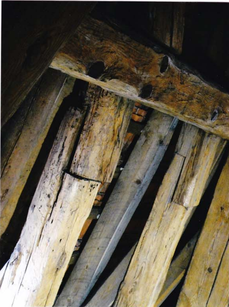
fot.16. Skrzydło południowe – I kondygnacja. Odkształcone połączenia krokwi, w wyniku niewłaściwego wykonania. Tak połączone elementy nie są w stanie przenieść działających obciążeń.
