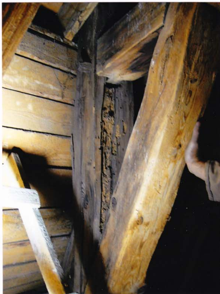
fot.108. Helm północny – dolna partia helmu. Widoczny słup drewniany głęboko zniszczony przez owada Spuszczela, z głębokimi ubytkami drewna.
