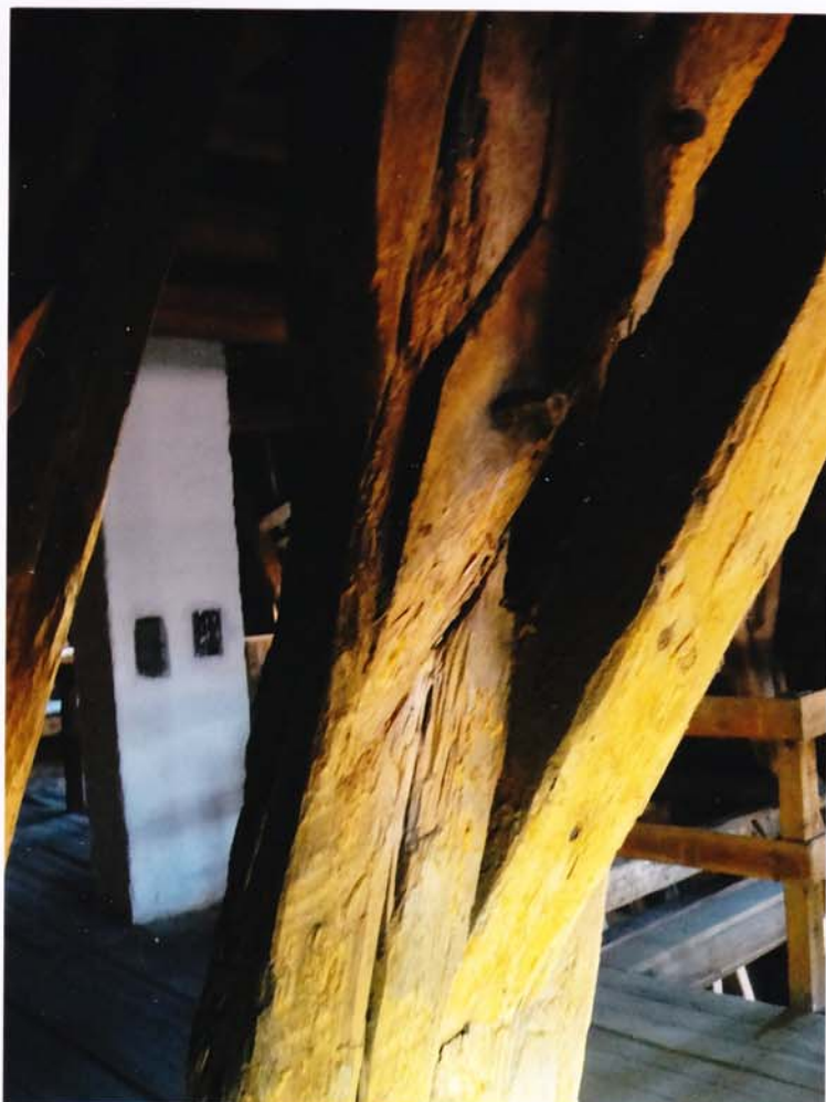
fot.54. Skrzydło północne – II kondygnacja. Fragment konstrukcji rozporowej. Wszystkie elementy w połączeniu zniszczone przez owada Spuszczela, z ubytkami drewna. Zastrzał jest znacznie przemieszczony – w połączeniu szerokie szczeliny.
