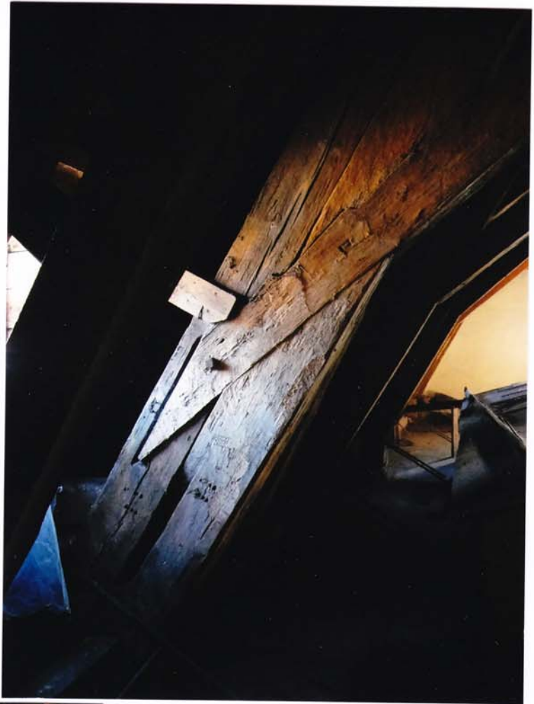
fot.59. Skrzydło północne – I kondygnacja. Konstrukcja rozporowa – w połączeniu widoczne przemieszczenie zastrzału i szeroka szczelina. Jeden z elementów jest spękany podłużnie.
