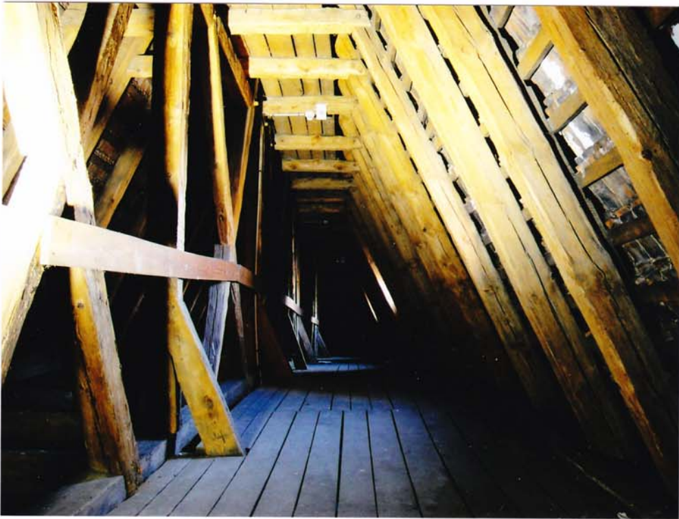
fot.9. Skrzydło południowe – III kondygnacja, widok ogólny. Widoczne znaczne odkształcenia pionowe więźby dachowej. Krokwie splekane podłużnie.
