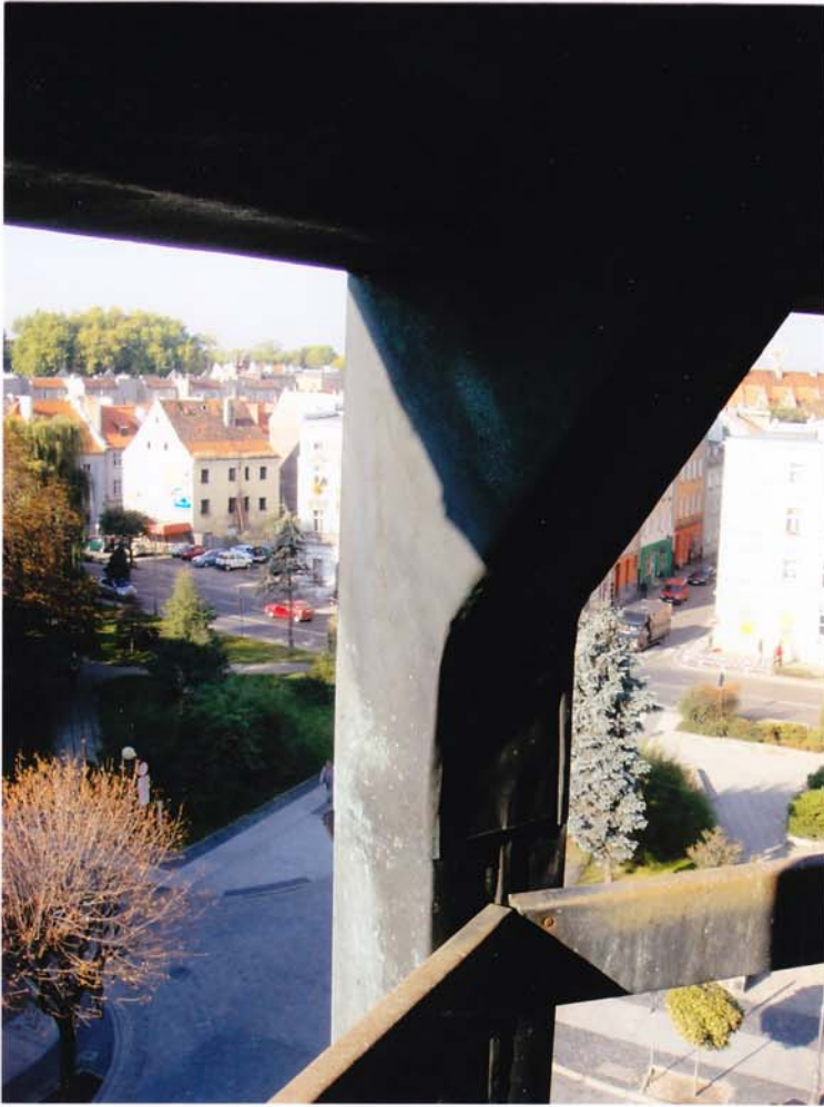
fot.95. Helm południowy – latarnia. Widoczne zbliżenie drewnianego słupa obwodowego, pokrytego szczelnie blachą miedzianą.
