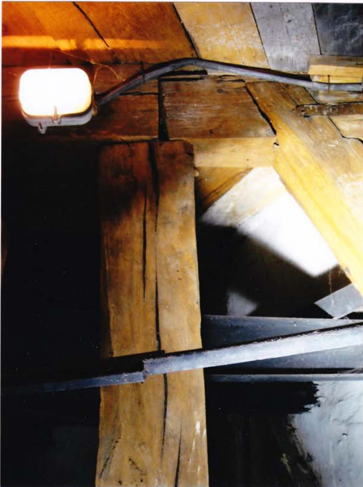
fot.84. Konstrukcja wsporczą niosąca helm – V kondygnacja. Widoczne niewłaściwie wykonane sztukowanie elementów w połączeniu. Słup jest silnie spękany podłużnie.
