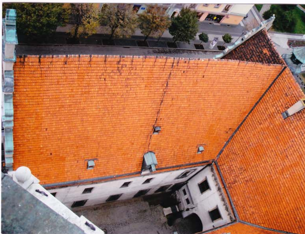
fot.2. Dach skrzydła południowego w widoku z góry. W kalenicy dachu widoczne odkształcenie poziome. Po prawej stronie dach skrzydła zachodniego.
