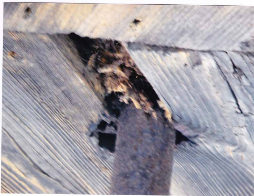
fot.70. Dolna latarnia – fragment stropu nad latarnią. Przy rurze stalowej widoczne gniazdowe zniszczenie deski przez grzyb, z ubytkiem drewna.
