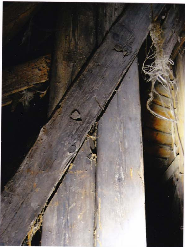
fot.99. Helm południowy – dolna partia helmu. Rozluźnione połączenie konstrukcji helmu, widoczne szerokie szczeliny między elementami.
