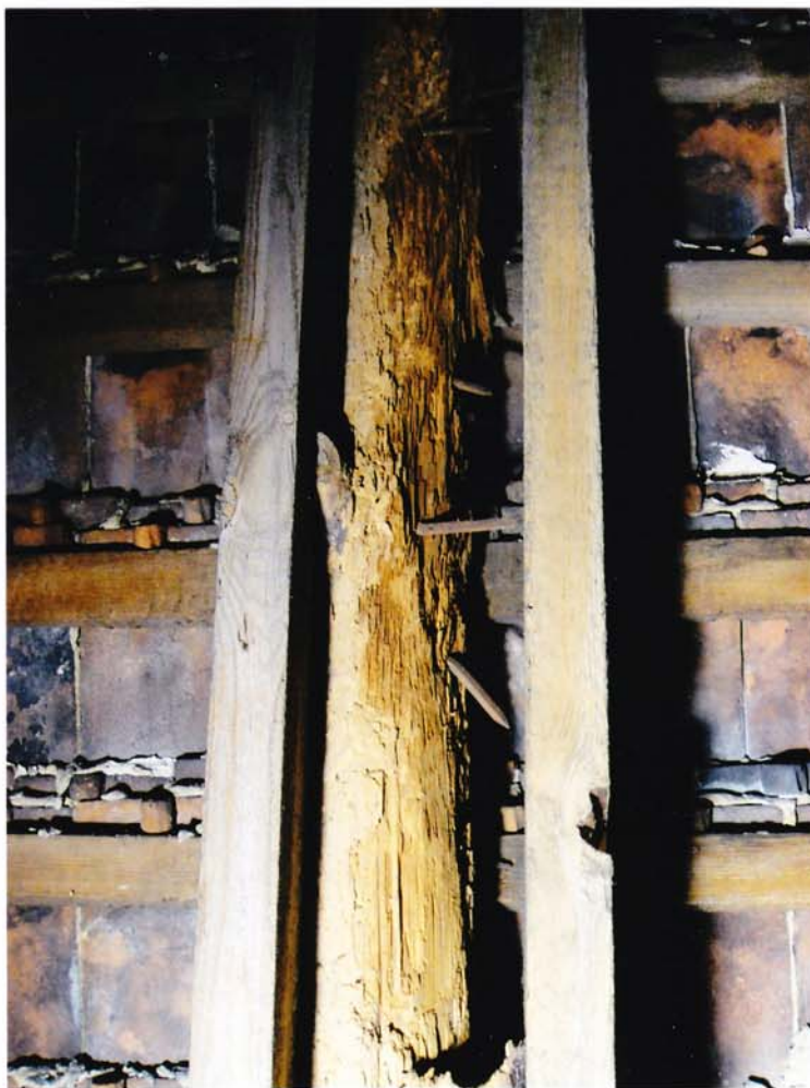
fot.25. Skrzydło zachodnie – III kondygnacja. Krokiew głęboko zniszczona przez grzyb z głębokimi ubytkami. Krokiew jest wzmocniona obustronnie przykładkami drewnianymi.
