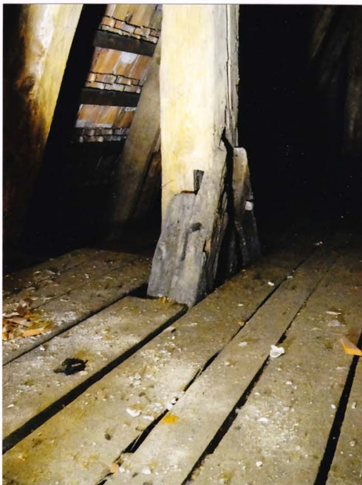
fot.22. Skrzydło zachodnie – IV kondygnacja. Połączenie słupa z mieczami – miecze są znacznie wysunięte z gniazda.
