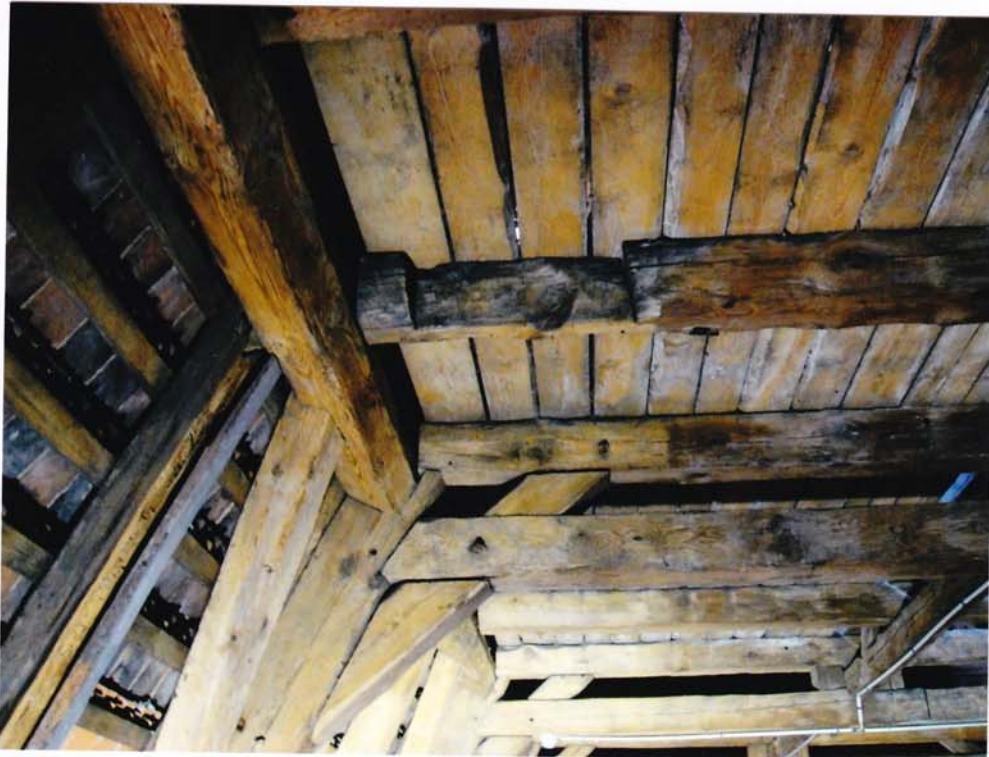
fot.12. Skrzydło południowe – II kondygnacja. Znaczące rozluźnienie i szczeliny w połączeniu elementów konstrukcji rozporowej. Po lewej stronie krokiew głęboko zniszczona przez owada Spuszczela, z głębokimi ubytkami drewna.
