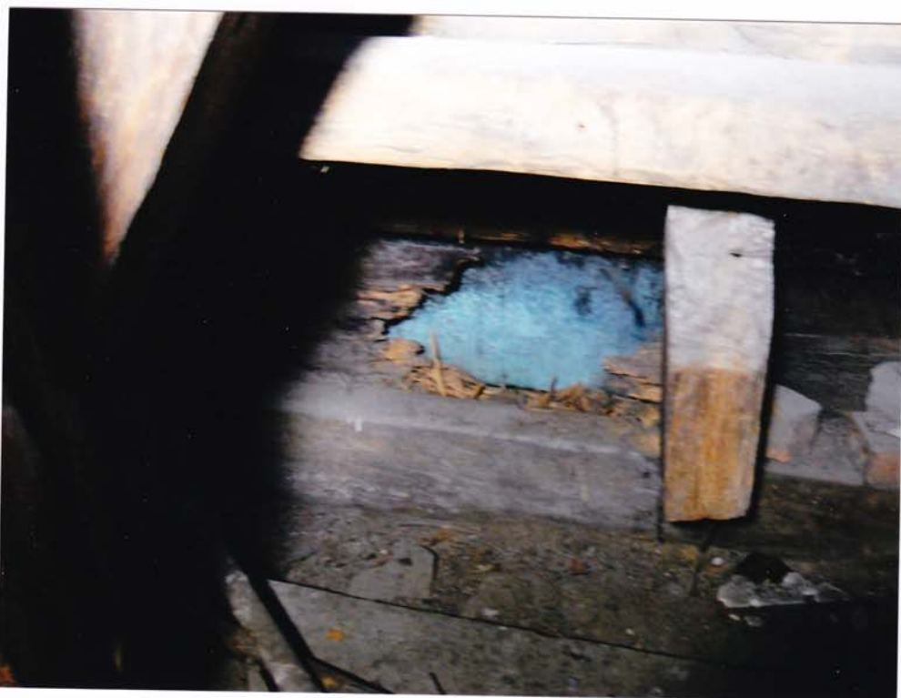
fot.73. Dolna partia helmu – widoczne od wnętrza pokrycie blachą i zniszczone przez grzyb deski pokrycia ze znacznym ubytkiem. Poniżej murlata głęboko zniszczona przez grzyb z głębokim ubytkiem drewna.
