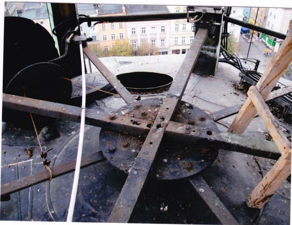
fot.72. Dolna latarnia – widoczne pokrycie blachą miedzianą stropu nad dolną partią helmu. Wokół obwodowe słupy drewniane pokryte blachą. Ponad stropem stalowa konstrukcja spinająca słupy obwodowe, elementy konstrukcji powierzchniowo i głęboko skorodowane, z ubytkami stali.
