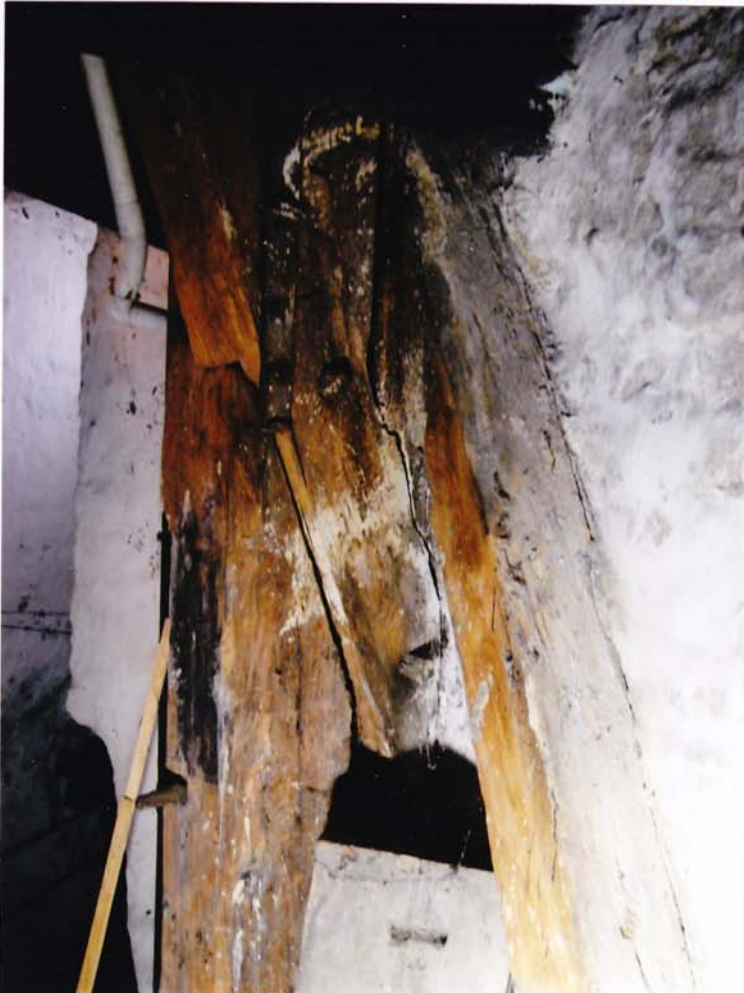
fot.82. Konstrukcja wsporcza niosąca helm – V kondygnacja. Widoczne połączenie słupa z zastrzałem, w połączeniu między elementami szczeliny.
