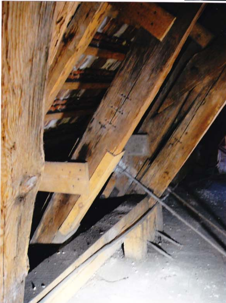
fot.60. Skrzydło północne – I kondygnacja. Krokiew z wstawionym elementem nowym w miejscu wyciętej zniszczonej partii. W głębi szeroka szczelina w połączeniu konstrukcji rozporowej.
