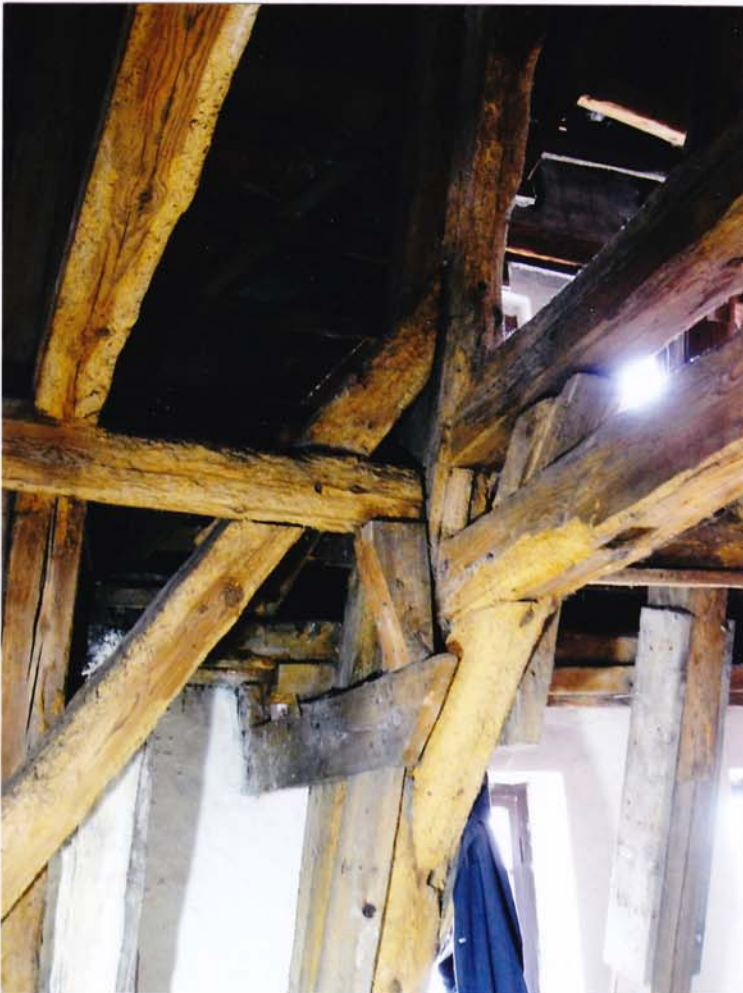
fot.38. Skrzydło zachodnie – I kondygnacja. Liczne elementy są głęboko zniszczone przez owada Spuszczela, z głębokimi ubytkami drewna.
