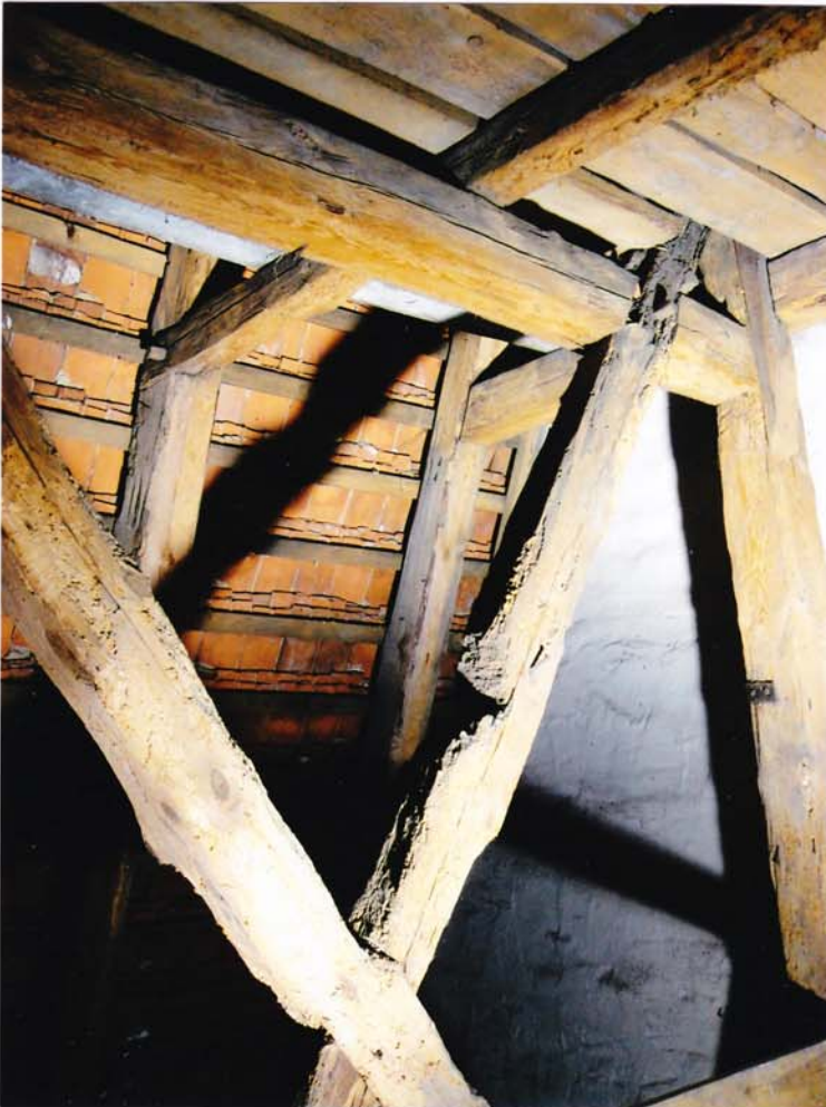
fot.10. Skrzydło południowe – III kondygnacja. Zastrzały całkowicie zniszczone przez owada Spuszczela, z głębokimi ubytkami drewna.
