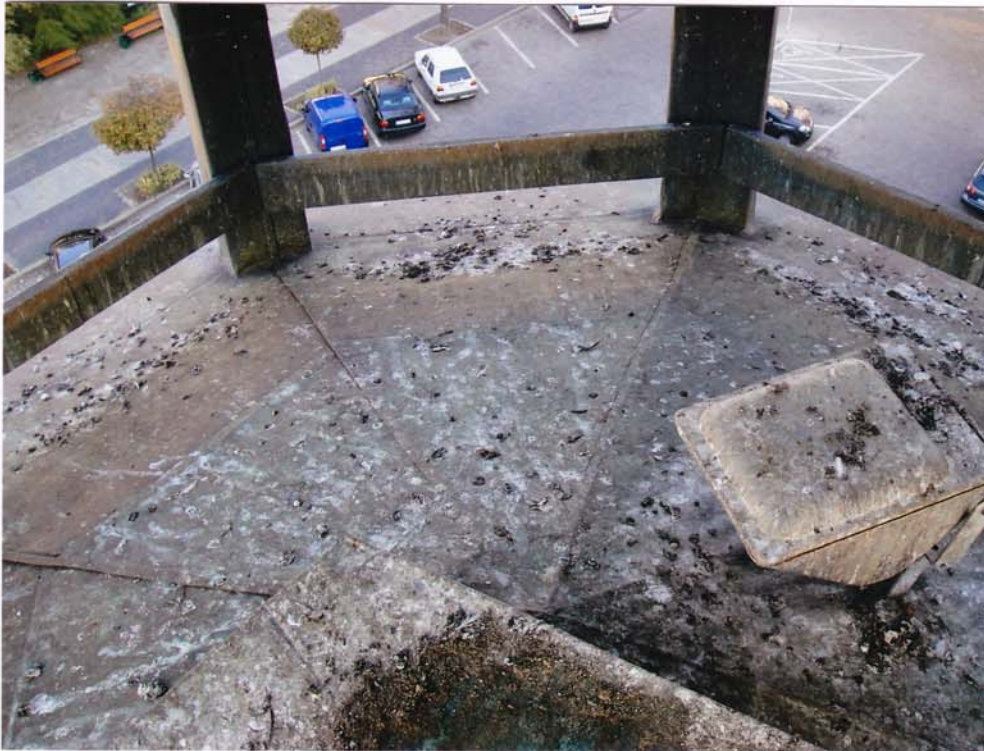
fot.94. Hełm południowy – latarnia. Widoczne pokrycie blachą miedzianą stropu nad dolną partią helmu. W głębi drewniane słupy obwodowe pokryte szczelnie blachą miedzianą.
