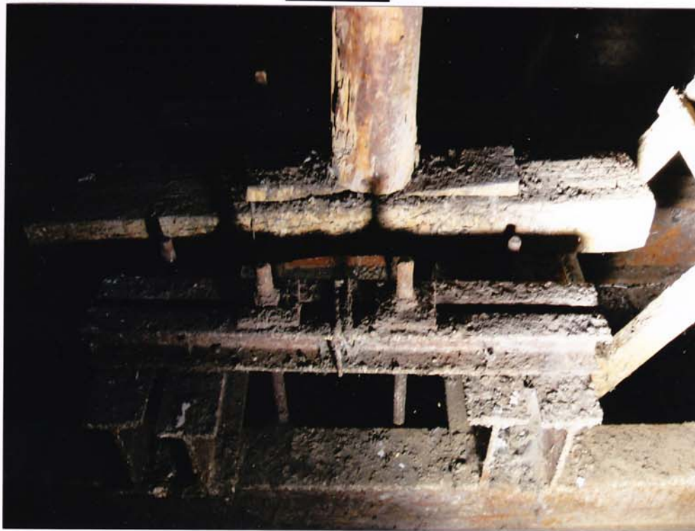
fot.100. Helm południowy – dolna partia helmu. Oparcie słupa centralnego helmu na stalowej konstrukcji wzmacniającej.
