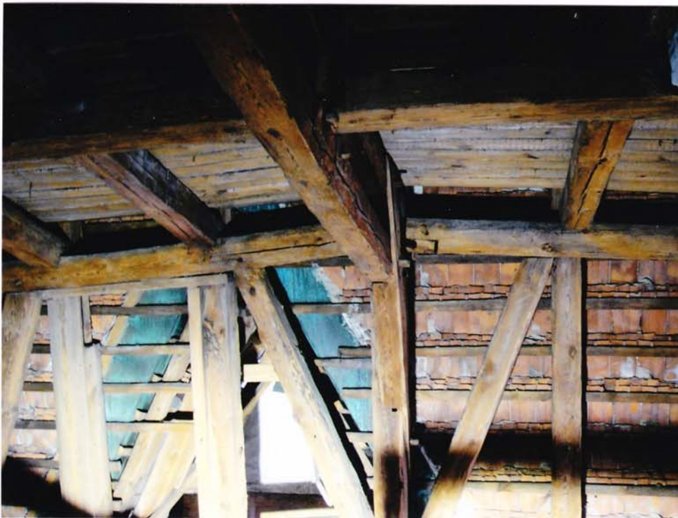
fot.30. Skrzydło zachodnie – II kondygnacja. Widoczne znaczne pionowe odkształcenie więźby dachowej. Płatew jest pęknięta podłużnie i wysunięta z połączenia. Rygiel konstrukcji rozporowej i belki stropu są spękane podłużnie.
