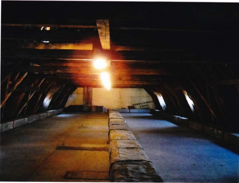
fot.15. Skrzydło południowe – I kondygnacja, widok ogólny. Widoczna konstrukcja rozporowa więźby dachowej.
