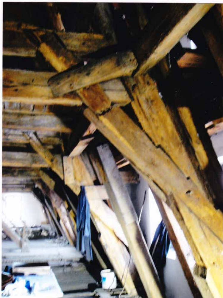
fot.40. Skrzydło zachodnie – I kondygnacja. Zastrzał konstrukcji rozporowej jest rozerwany w wyniku rozciągania. W licznych elementach powierzchniowe i głębokie zniszczenia przez owada Spuszczela.
