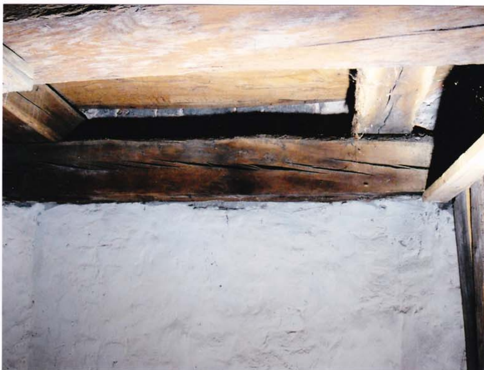
fot.89. Konstrukcja wsporcza niosąca helim – I kondygnacja. Podciąg spękany podłużnie na całej długości.
