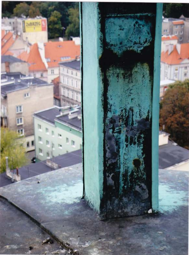
fot.66. Górna latarnia – widoczne zbliżenie drewnianego słupa obwodowego pokrytego szczelnie blachą miedzianą.
