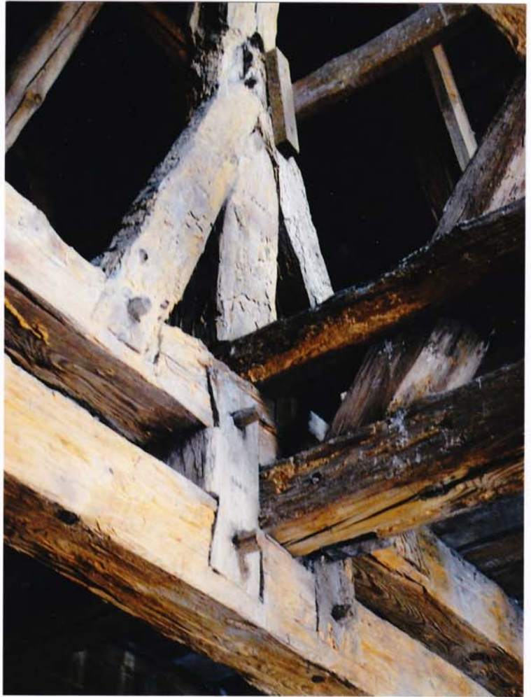
fot.31. Skrzydło zachodnie – II kondygnacja. Widoczne elementy poziome są zniszczone przez grzyb, ze znacznymi ubytkami drewna. Górą zniszczone połączenie mieczy ze słupem.
