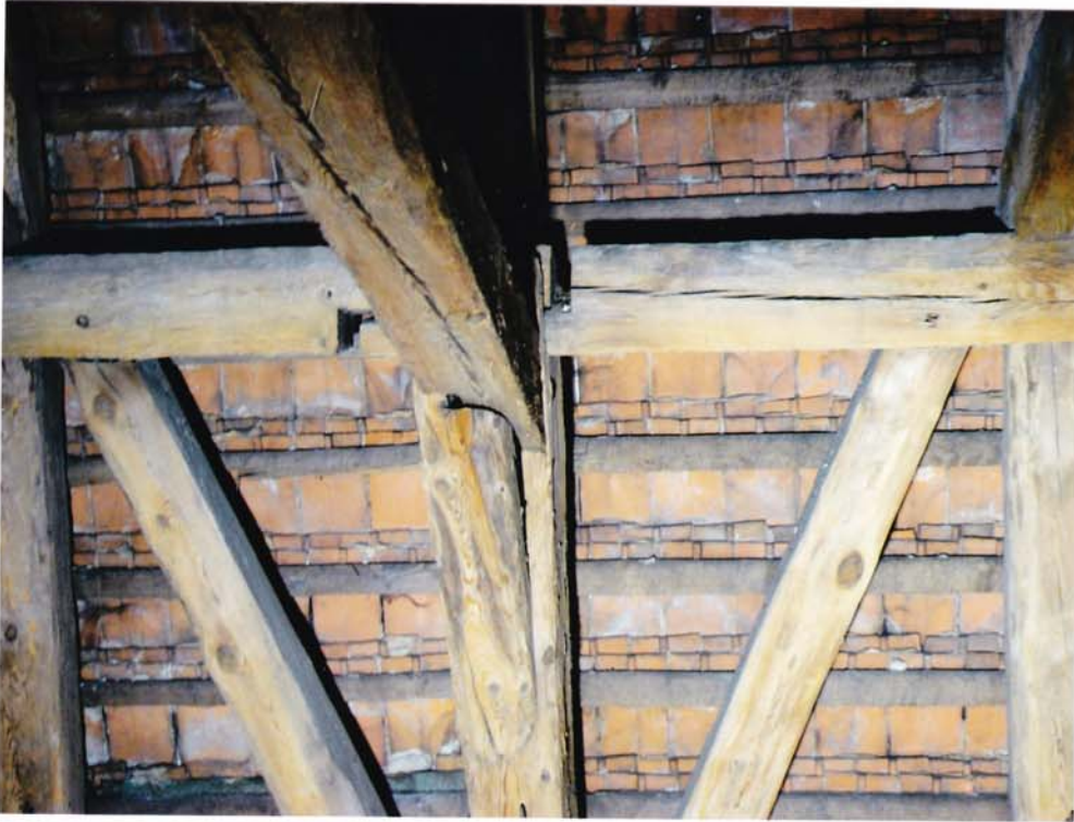
fot.13. Skrzydło południowe – II kondygnacja. Płatwie wysunięte z połączenia, w wyniku poziomego odkształcenia więźby dachowej. W połączeniu znaczna szczelina między elementami. Część elementów jest spękanych podłużnie.
