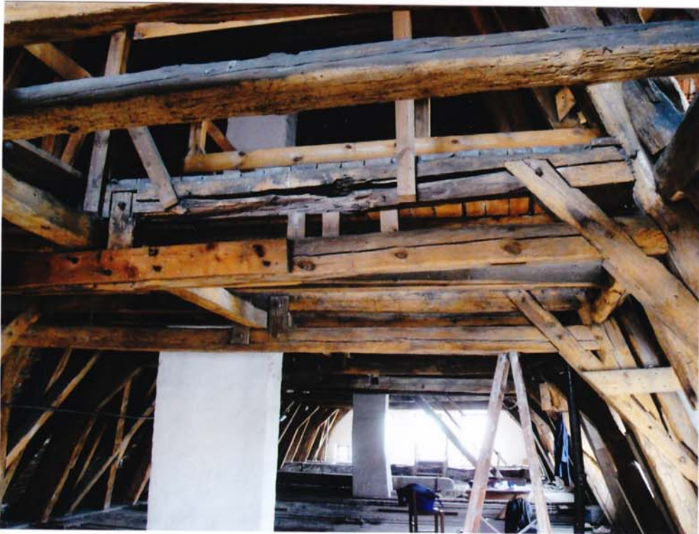
fot.35. Skrzydło zachodnie – I kondygnacja, widok ogólny. Widoczna konstrukcja rozporowa więźby dachowej. Na pierwszym planie spękane rygle. Dolny rygiel wzmocniony obustronnie przykładkami drewnianymi, łączonymi na śruby, o małej średnicy przy dużym rozstawie śrub. Górny rygiel całkowicie zniszczony w wyniku pęknięcia o dużej rozwartości.
