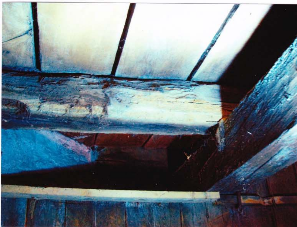
fot.90. Konstrukcja wsporcza niosąca helim – I kondygnacja. Belka stropu o rozległych zniszczeniach przez owada Spuszczela, górą ubytki drewna.
