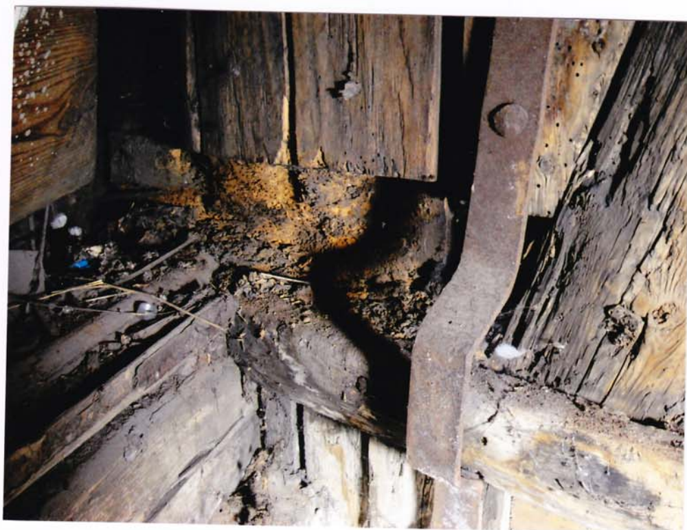
fot.80. Dolna partia helmu – widoczne połączenie słupa z belką stropu i podwaliną. W połączeniu elementy są głęboko zniszczone przez grzyb, z głębokimi ubytkami drewna. Widoczny element stalowy łączący słupy helmu ze słupami drewnianej konstrukcji wsporczej niosącej helm.
