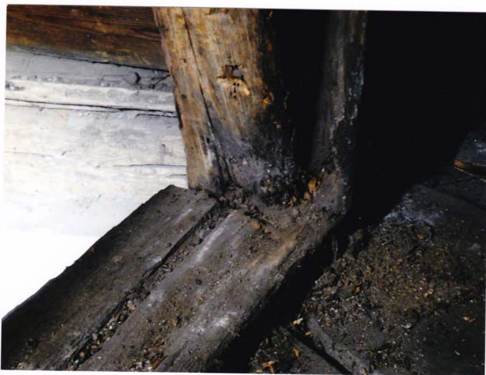
fot.79 Dolna partia helmu – widoczne połączenie słupa z belką stropu. Elementy w połączeniu są głęboko zniszczone przez grzyb, z ubytkami drewna.
