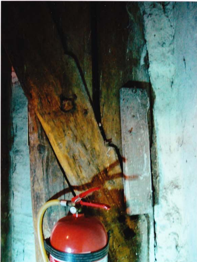
fot.86. Konstrukcja wsporcza niosąca hełm – IV kondygnacja. Widoczne połączenie słupa z zastrzałem. W połączeniu szeliny o znacznej rozwarości.
