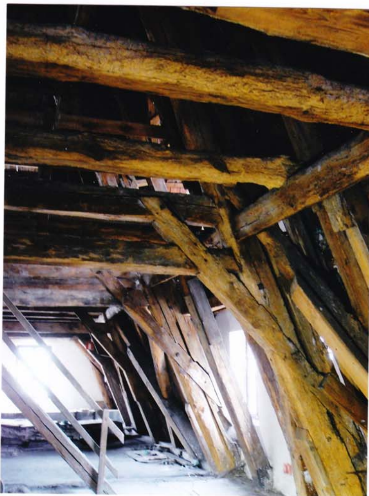
fot.39. Skrzydło zachodnie – I kondygnacja. Trsamy i elementy konstrukcji rozporowej są głęboko zniszczone przez owada Spuszczela, z głębokimi ubytkami drewna. W połączeniach widoczne znaczne szczeliny między elementami.
