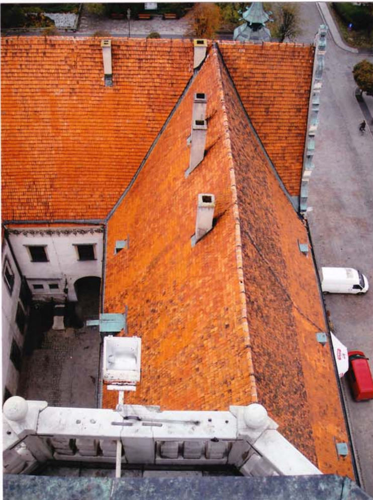
fot.4. Dach skrzydła północnego – widać odkształcenia poziome w kalenicy dachu. W głębi dach skrzydła zachodniego. Na dachach widoczne liczne zniszczone dachówki.
