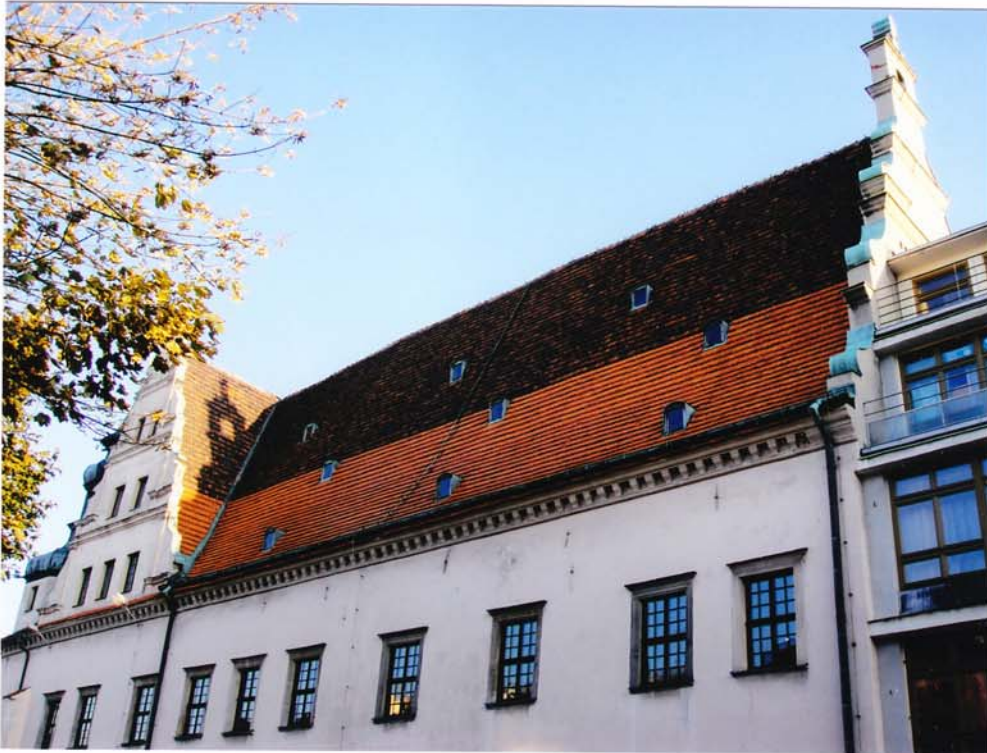
fot.7. Dach skrzydła południowego – połać południowa. Górą dachówki stare, dołem współczesne. Widoczne odkształcenia połaci dachowej. Na ścianach szczytowych obróbki z blachy miedzianej.
