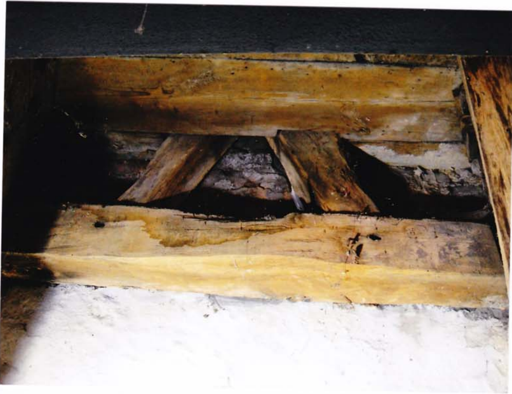
fot.85. Konstrukcja wsporcza niosąca hełm – IV kondygnacja. Widoczny element poziomy zniszczony gniazdowo przez grzyb, z ubytkami drewna. W głębi mur silnie zawilgocony.
