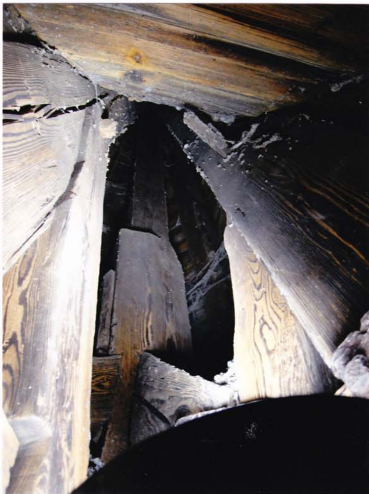
fol.63. Górna partia helmu w formie ostrosłupa 8-bocznego o znacznej smukłości. Widoczny drewniany słup centralny. Dołem zastrzał podłużnie pęknięty.
