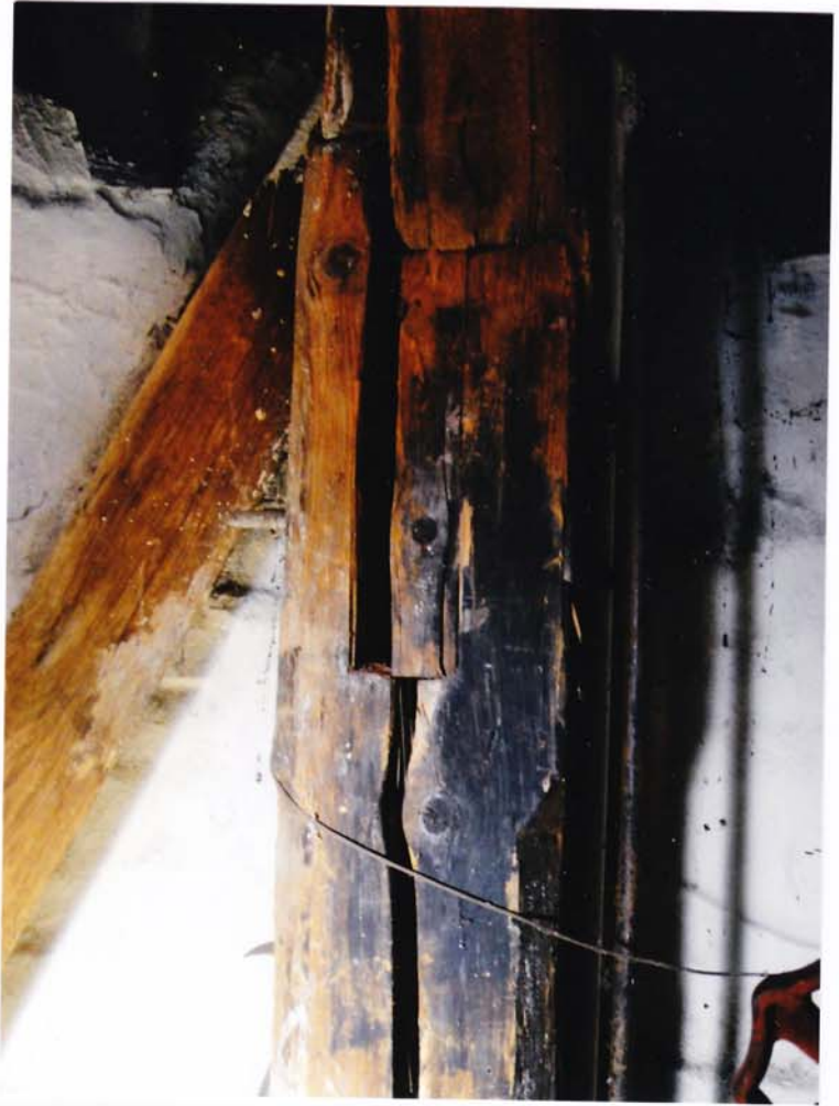
fot.81. Konstrukcja wsporcza niosąca helm – V kondygnacja. Widoczny silnie spękany słup – pęknięcia o znacznej rozwarłości.
