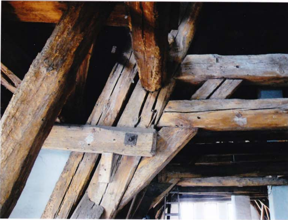
fot.37. Skrzydło zachodnie – I kondygnacja. Całkowicie zniszczony stolec leżący konstrukcji rozporowej, w wyniku spękania i złamania. Pozostałe elementy są spękane podłużnie.
