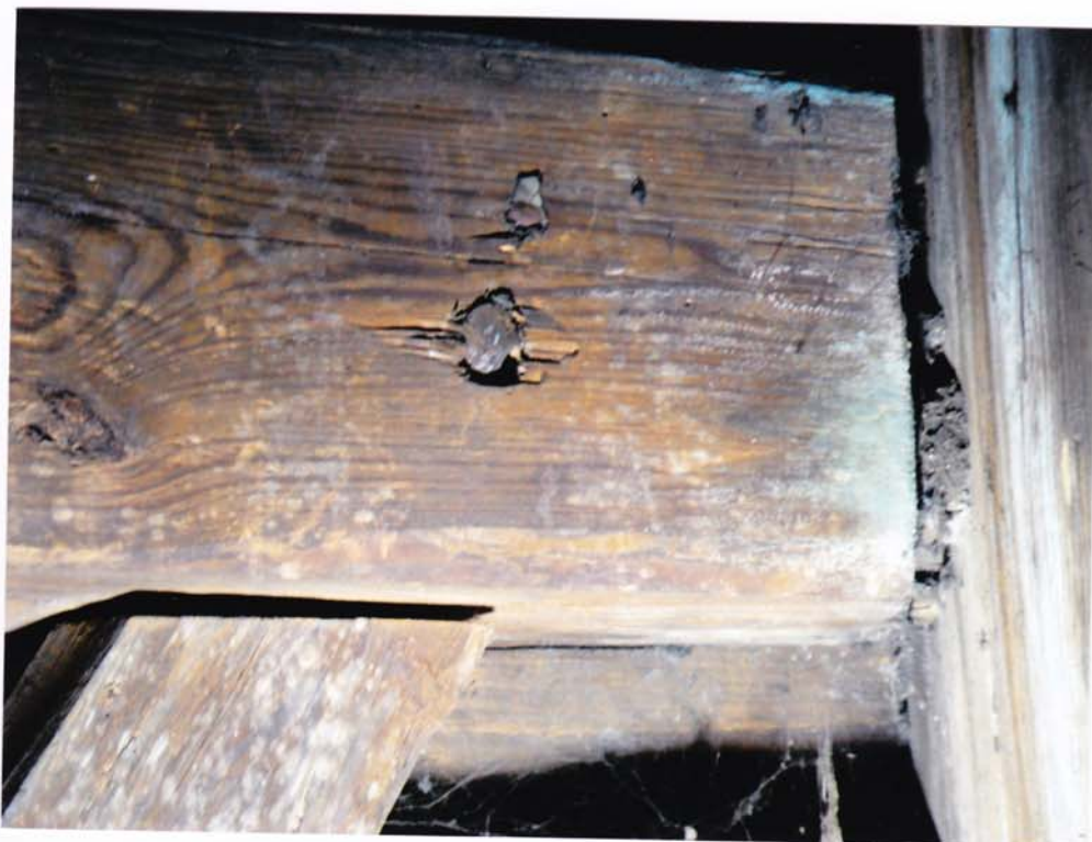
fot.77. Dolna partia helmu – w połączeniach widoczne szerokie szczeliny między elementami.
