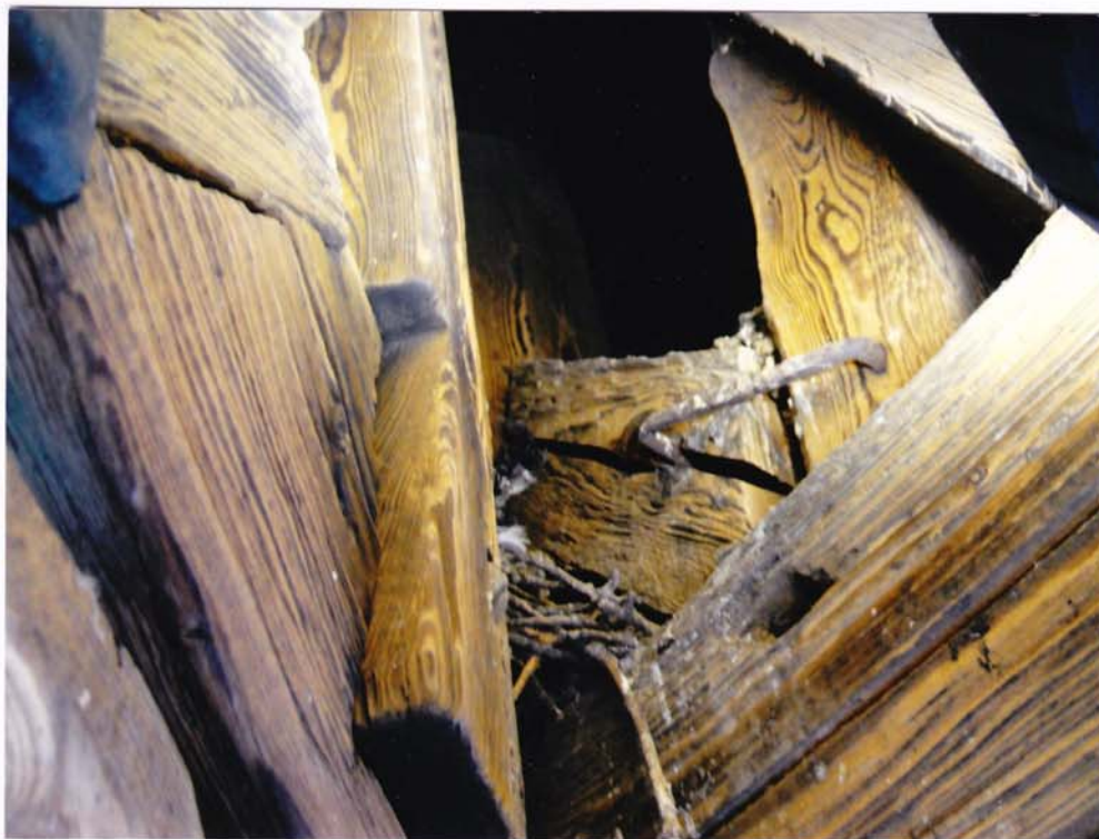
fol.64. Górna partia helmu. Widoczny zastrzał pęknięty wzdłuż i zmcowany klamrą ciesielską, której wbicie, bez uprzedniego wywiercenia otworu, spowodowało pęknięcie.
