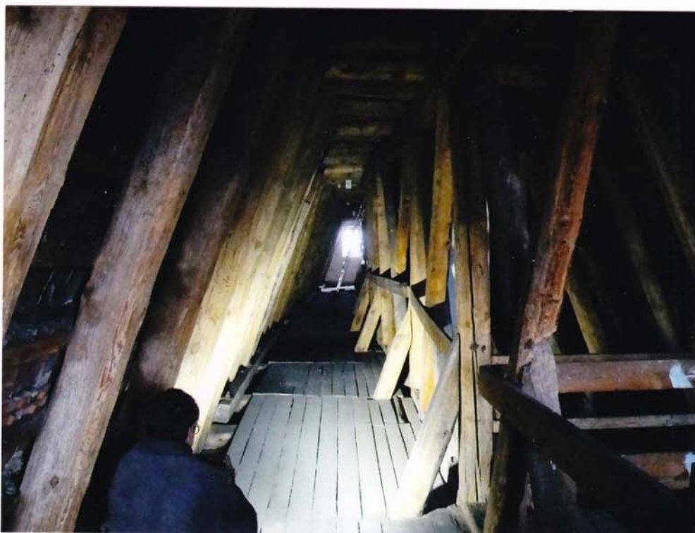
fot.23. Skrzydło zachodnie – III kondygnacja, widok ogólny. Widoczne znaczne odkształcenia pionowe i poziome więźby dachowej.
