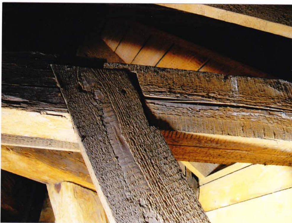
fot.107. Helm północny – dolna partia helmu. W węźle konstrukcji helmu widoczne połączenie (sztukowanie) elementu poziomego. Między elementem poziomym i zastrzałem szeroka szczelina.
