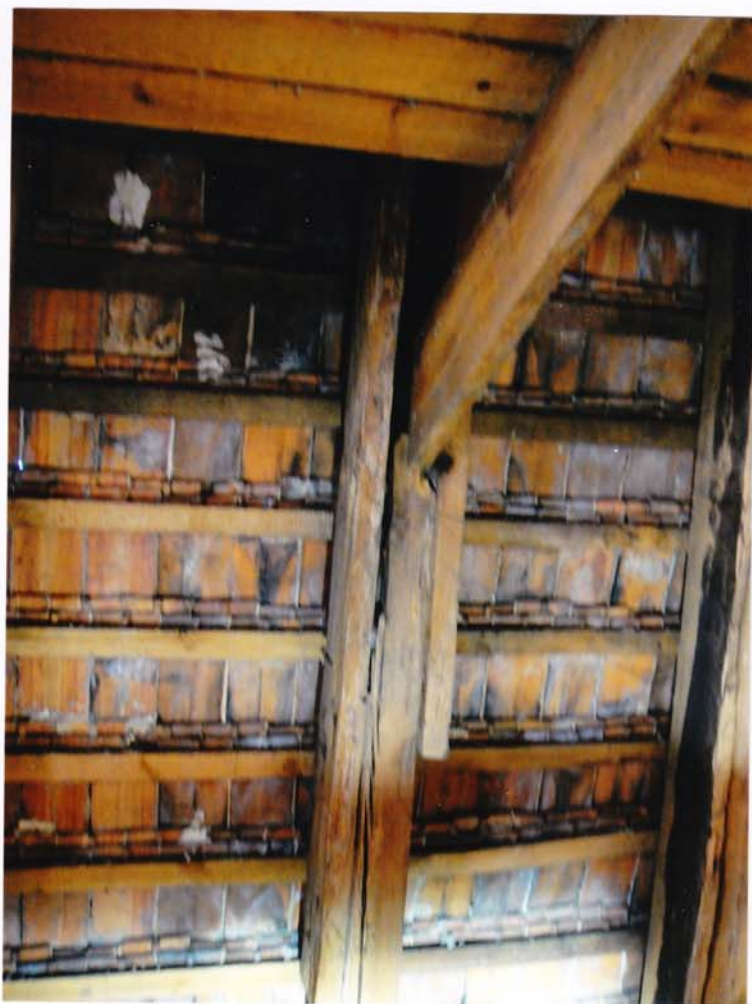
fot.50. Skrzydło północne – III kondygnacja. Krokiew całkowicie zniszczona w połączeniu przez grzyb z rozległym ubytkiem drewna na całą głębokość elementu. Krokiew jest obustronnie wzmocniona przykładkami drewnianymi.
