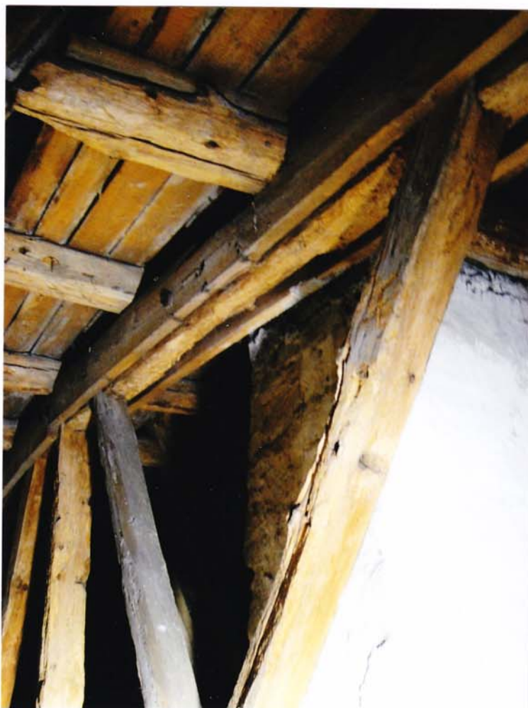
fot.27. Skrzydło zachodnie – III kondygnacja. Płatew, słup i zastrzał są głęboko zniszczone przez owada Spuszczela, z głębokimi ubytkami drewna. Płatew jest na całej długości wzmocniona obustronnymi przykładkami z drewna.
