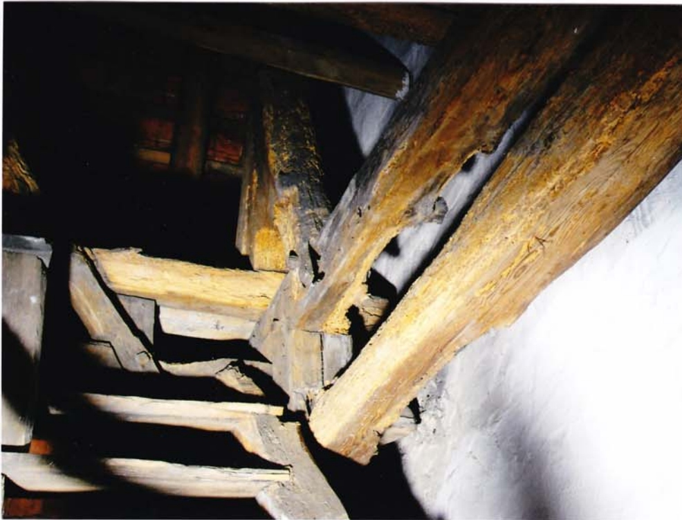
fot.14. Skrzydło południowe – II kondygnacja. Liczne elementy głęboko zniszczone przez owada Spuszczela, z głębokimi ubytkami drewna.
