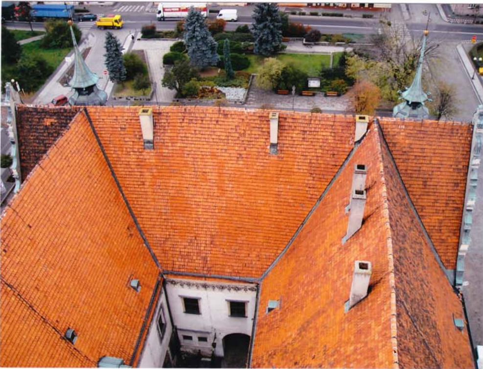
fot.3. W głębi dach skrzydła zachodniego, po lewej skrzydła południowego, a po prawej skrzydła północnego. Widoczne odkształcenie poziome w kalenicy dachu południowego. Na dachach widoczne liczne zniszczone dachówki.
