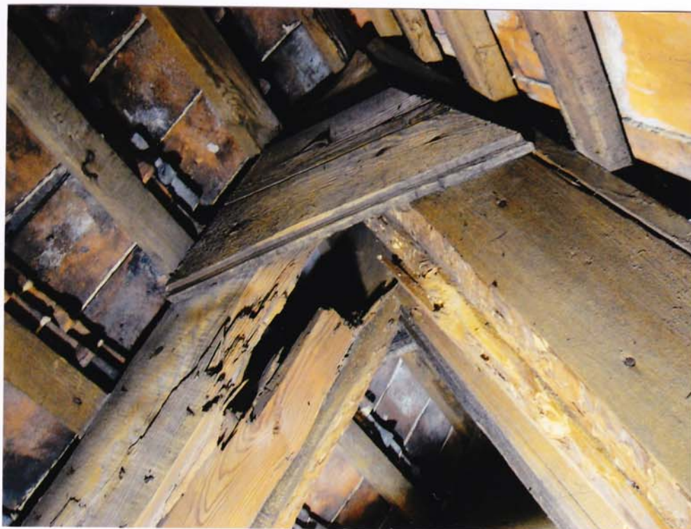
fot.48. Skrzydło północne – IV kondygnacja. Widoczna krokiew całkowicie zniszczona w kalenicy przez grzyb, z ubytkiem drewna na całą głębokość elementu. Obie krokwie są wzmocnione obustronnie przykładkami drewnianymi i górą poprzeczkami drewnianymi.
