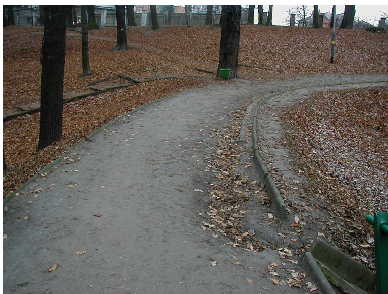
Zniszczenia nawierzchni alejki z widocznymi pozostałościami ścieku
