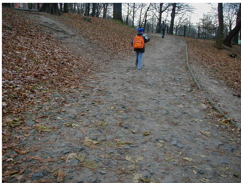
Stan nawierzchni alejki w jej zachodniej części – kamień łamany
