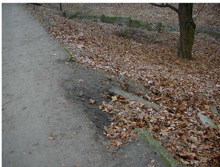
Zniszczenia nawierzchni alejki spowodowane spływem wód deszczowych
