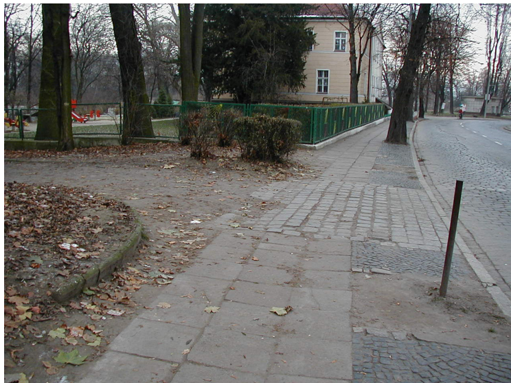
Nawierzchnia chodnika ul. Chrobrego na połączeniu z alejką
