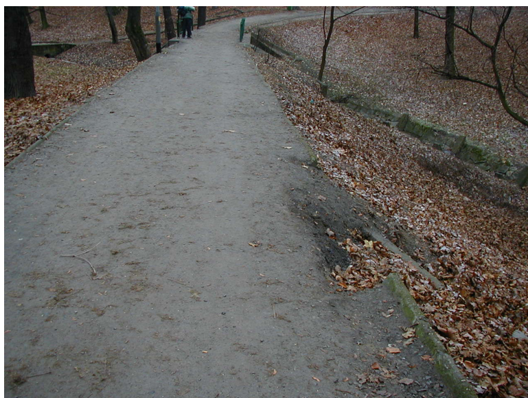
Zniszczenia nawierzchni alejki spowodowane spływem wód deszczowych
