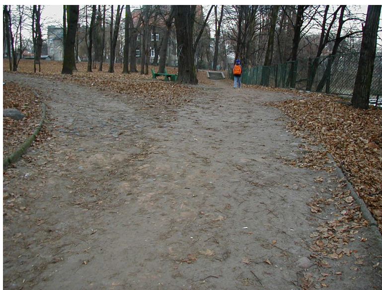
Stan nawierzchni alejki w jej zachodniej części
