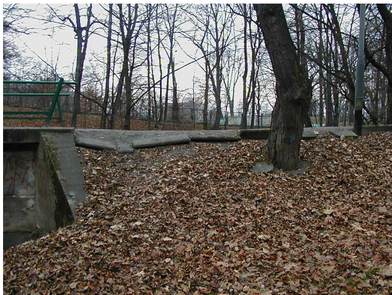
Zniszczenia nawierzchni alejki
