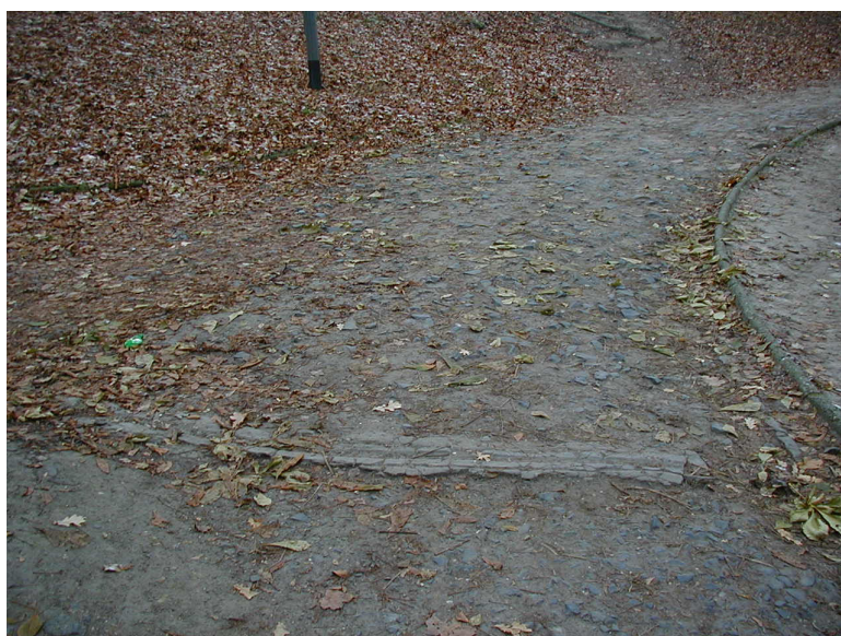
Stan nawierzchni alejki w jej zachodniej części
