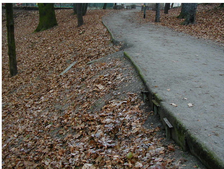
Zniszczenia nawierzchni alejki spowodowane spływem wód deszczowych
