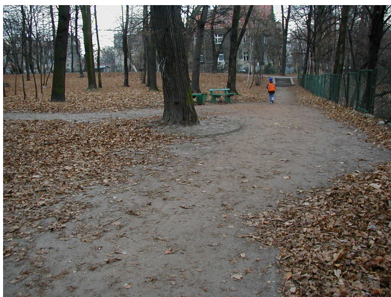
Stan nawierzchni alejki w jej zachodniej części
