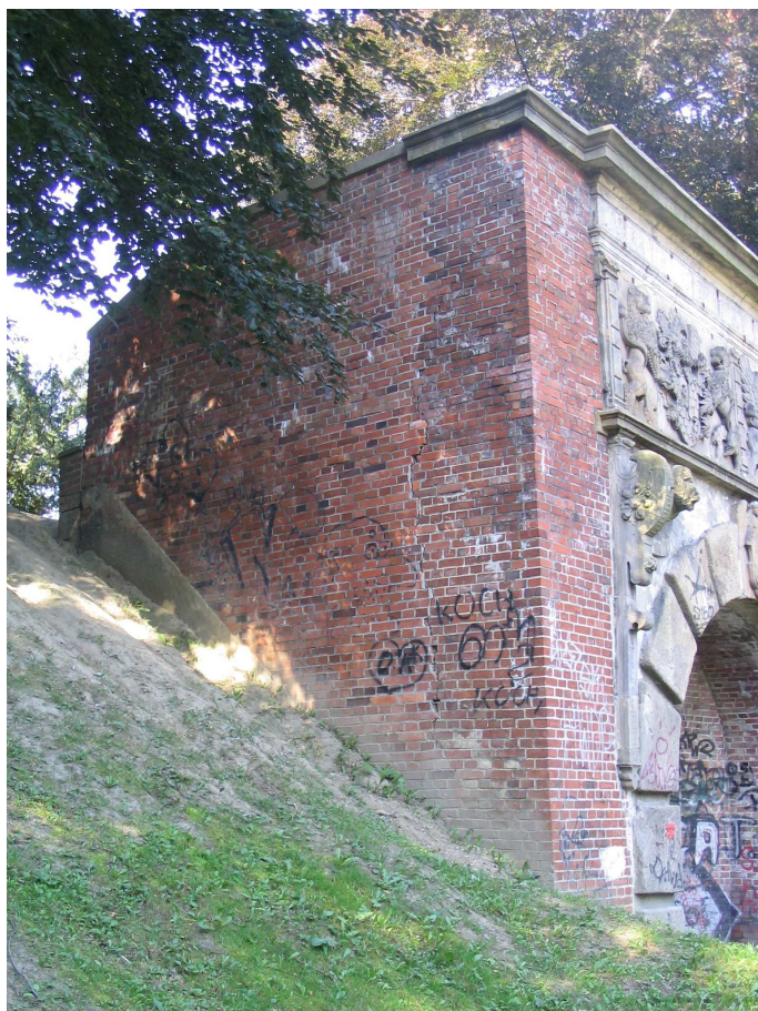
Fot. 2 Widok ściany południowo-wschodniej. Widoczne spękanie pionowe na styku ze ścianą czołową.
