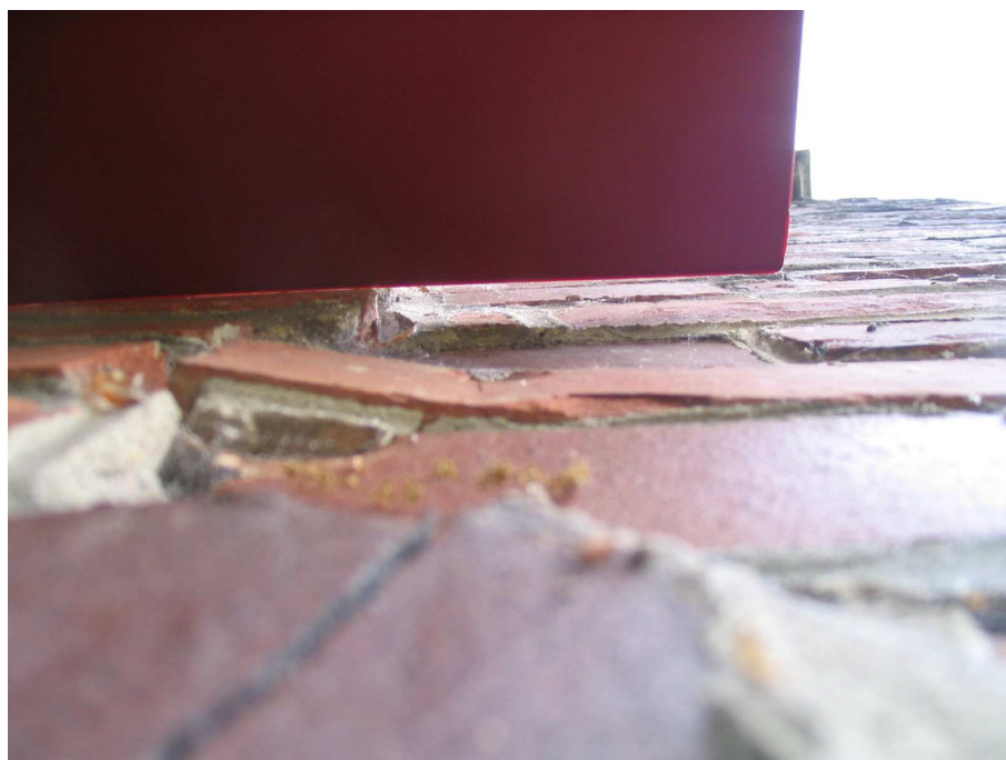
Fot. 8 Fragment ściany południowo-wschodniej. Widoczne spękanie. Przemieszczenie w płaszczyźnie prostopadłej do ściany.
