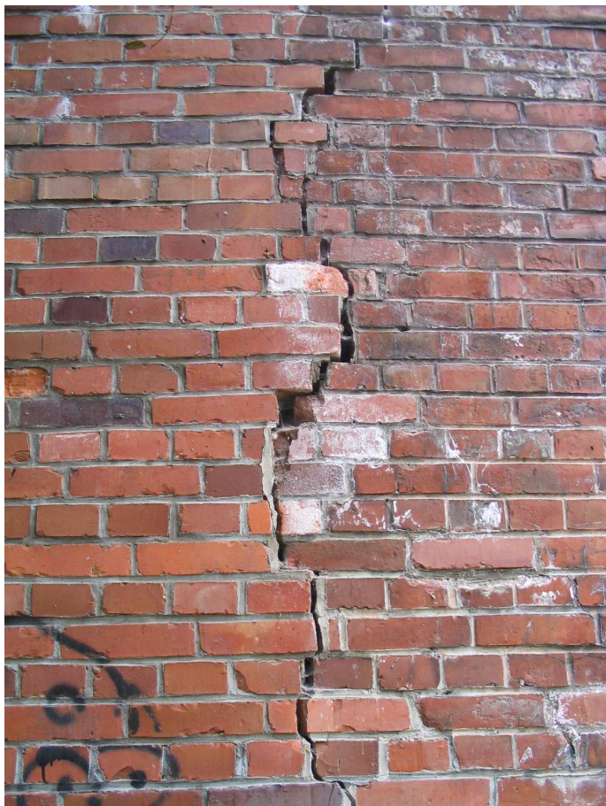
Fot. 7 Fragment ściany południowo-wschodniej. Widoczne spękanie. Przemieszczenie w płaszczyźnie ściany.
