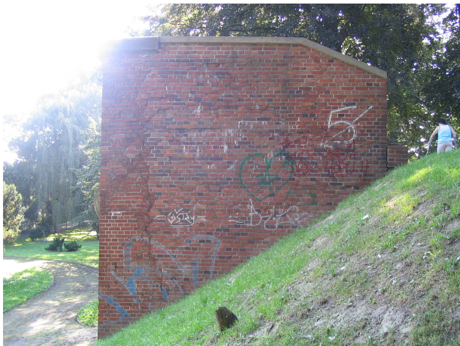
Fot. 3 Widok ściany północno-zachodniej. Widoczne spękanie pionowe na styku ze ścianą czołową
