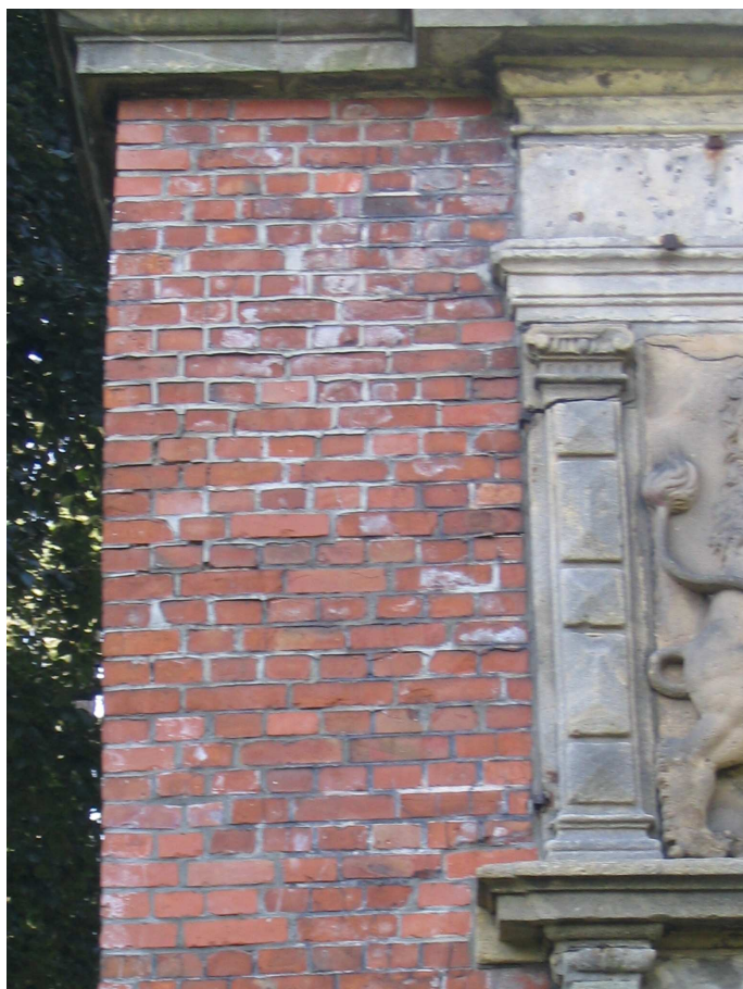
Fot. 6 Widok narożnika ściany czołowej. Widoczne uszkodzenia spoin.
