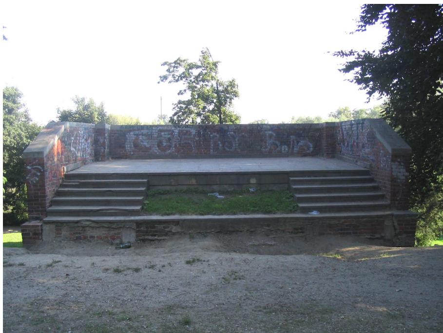
Fot. 4 Widok ściany tylnej. Widoczne obniżenie terenu przy ścianie.
