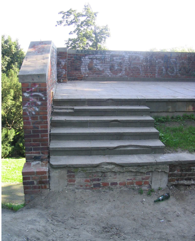
Fot. 9 Fragment tarasu. Widoczne : nieotynkowana i nie izolowana ściana tylna oraz ubytki płytek schodowych.
